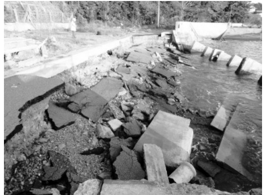
写真28：崩落した道路・堤防はまだ復旧せず
