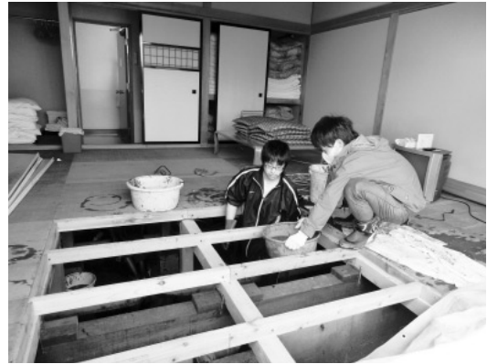
写真11：民宿「くりこ」の床下に溜まった泥水の掃除
