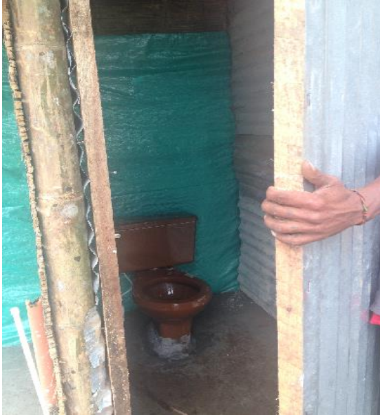
Figura 32. Servicio Sanitario O4
