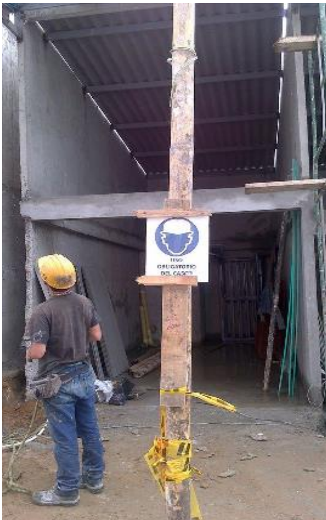
Figura 39. Letrero con medida de protección E4O2
