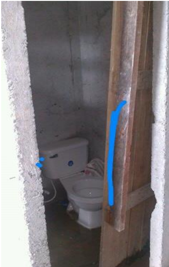
Figura 38. Servicio sanitario obra E4O2
