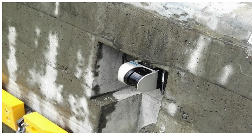
Figura 23: Sensor de presencia instalado en las esclusas de Cocolí
