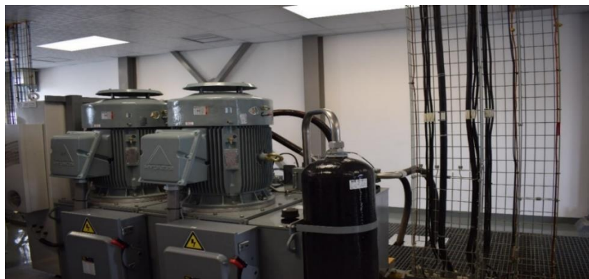
Figura 26: Sistema de potencia para accionamiento de válvulas
