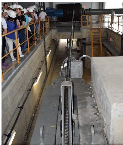
Figura 26. Componentes compuertas rodantes
