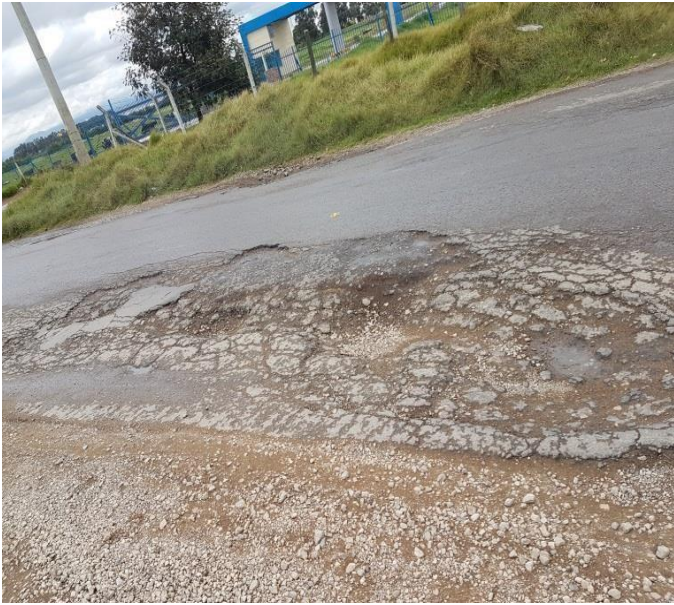
Desprendimiento de carpeta de rodadura
