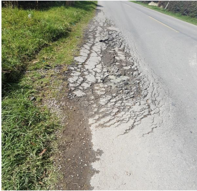
Perdida de adherencia de la carpeta
