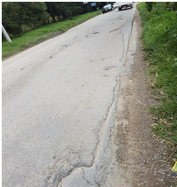
Desprendimiento de la sobrecarpeta
