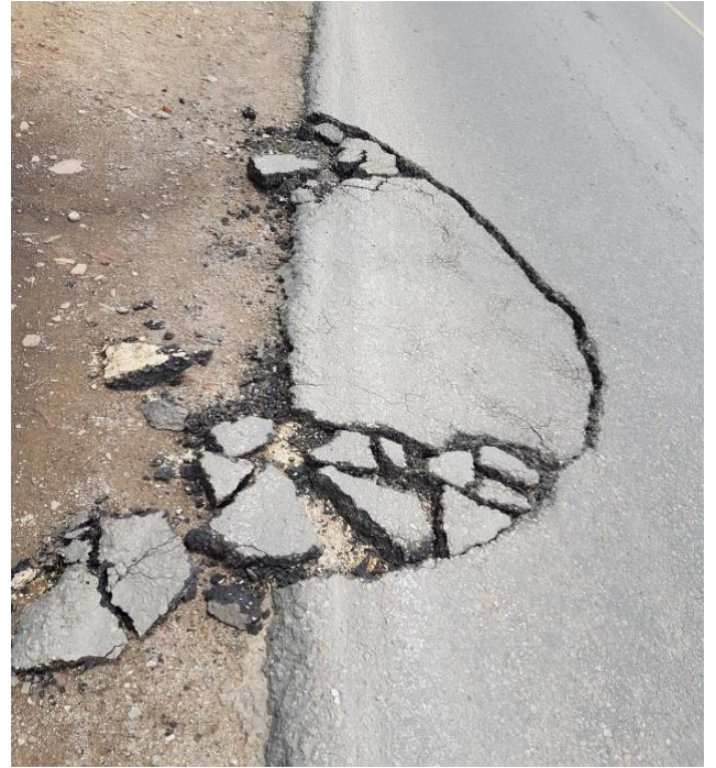
Desprendimiento de la carpeta con fisura media luna
