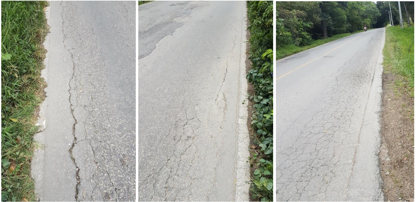
Fisuras de borde paralelas al eje de la via
