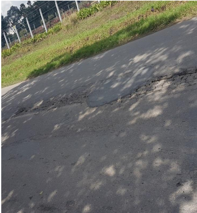
Fisuras de bloque y parcheo
