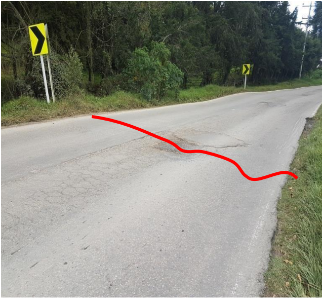
Hundimiento en zona de las huellas vehiculares
