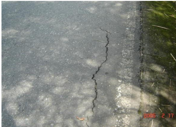
Figura 37 Fisuras de borde
