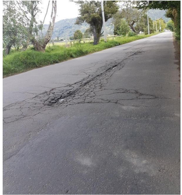
Fisuras en bloque con bache y hundimiento
