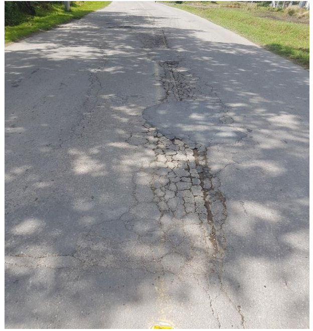
Fisura de bloque
