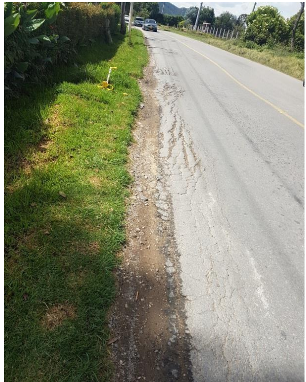
Fisura de borde
