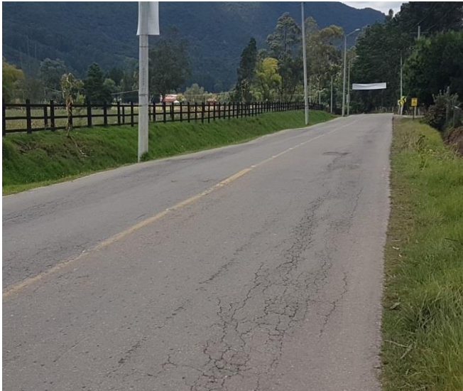
Fisuras de bloque
