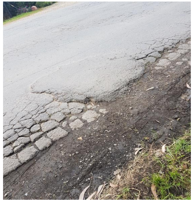
Piel de cocodrilo con presencia de parche
