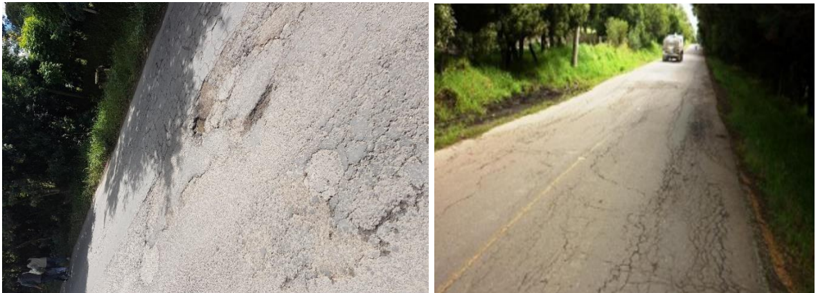
Figura 609 (a) Piel de cocodrilo (Autor, 2017) y (b) combinación de daños
