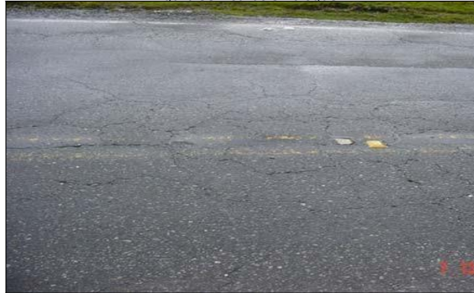
Figura 38 Fisuras en bloque
