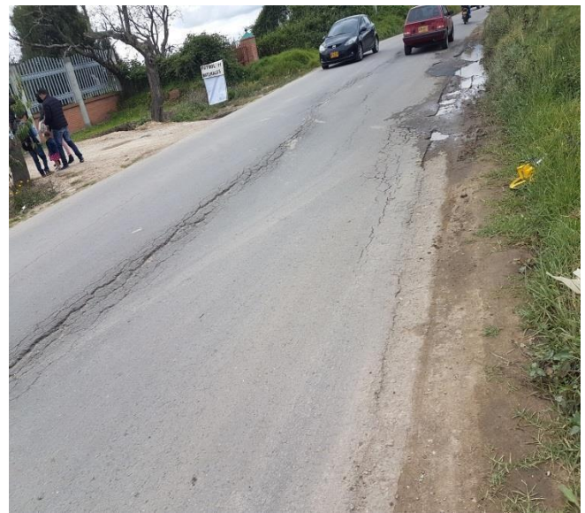
Fisuramiento en el eje de la vía altitud
