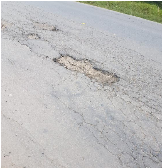
Piel de cocodrilo con presencia de bache
