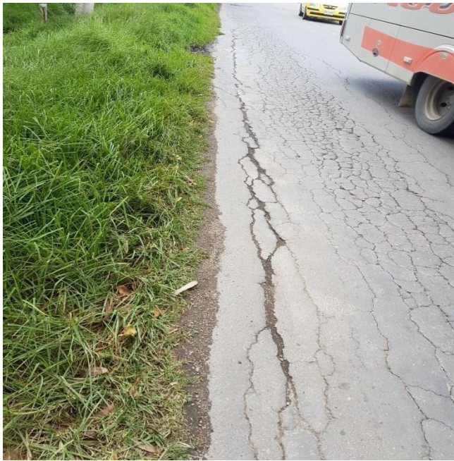
Fisura de borde con abultamiento
