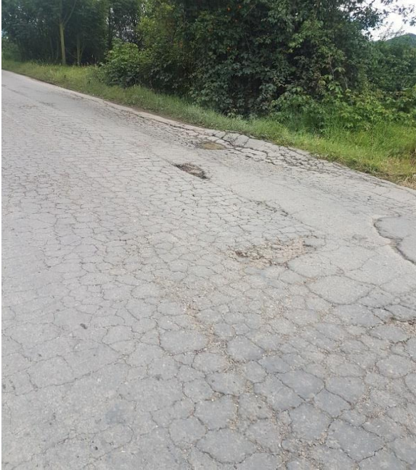
Piel de cocodrilo con presencia de baches
