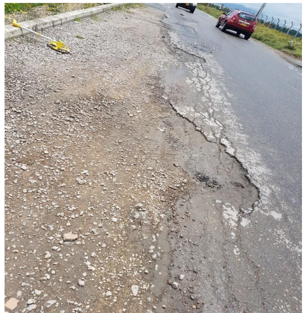
Perdida de la carpeta de rodadura con piel de cocodrilo
