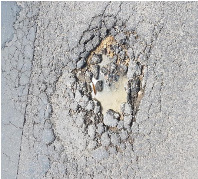
Desprendimiento del material de la carpeta
