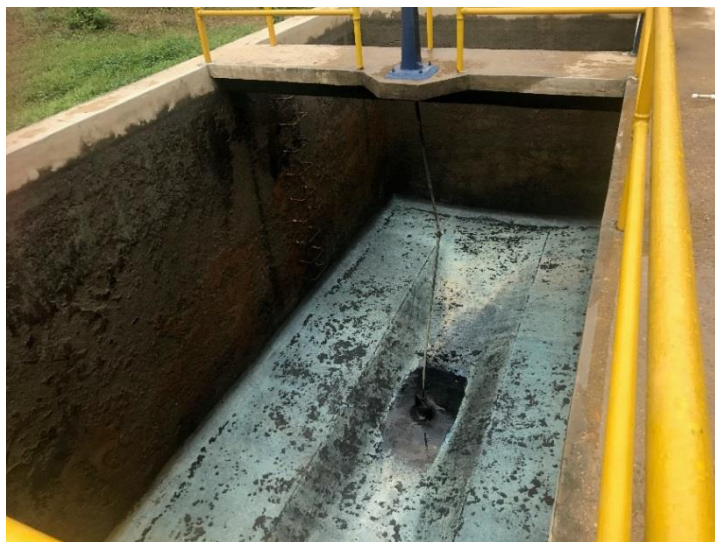
Figura. 4-13. Tanque de Almacenamiento – PTAP Río Bogotá.
