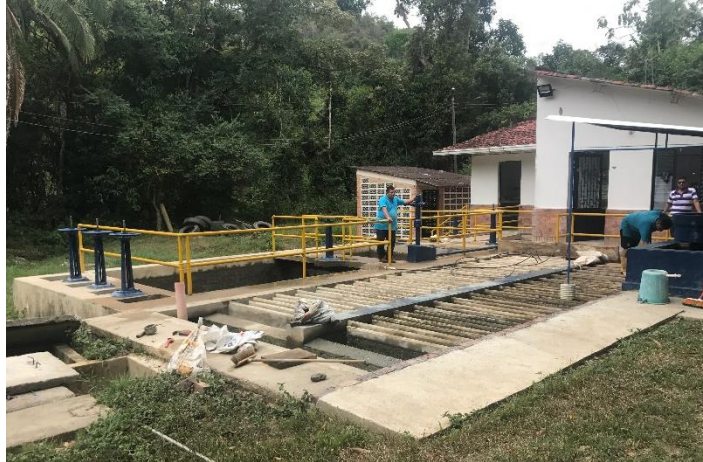
Figura. 4-12. Planta de Tratamiento de Agua Potable Río Bogotá.
