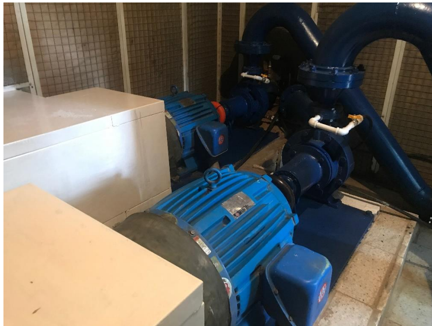
Figura. 4-11. Sistema de Bombeo Mesa de Yeguas.
