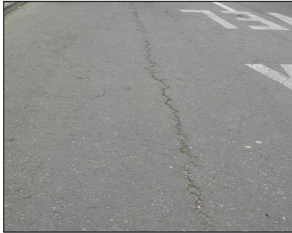
Figura 4. Fisura Longitudinal (FL)
