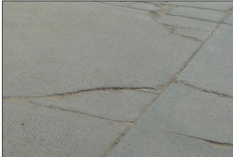
Figura 27. Grietas de Esquina (GE)
