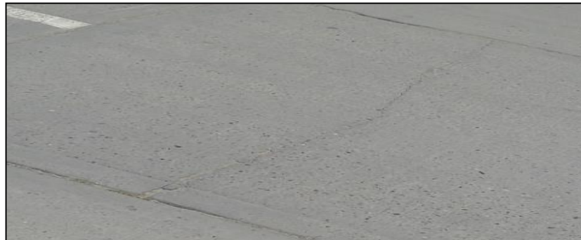
Figura 29. Grietas Transversales (GT)
