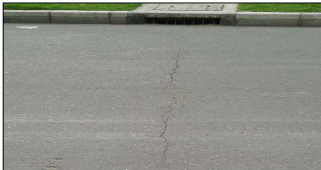
Figura 5. Fisura Transversal (FT)
