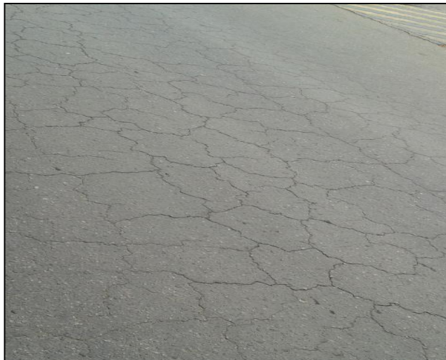
Figura 110. Fisuras en Bloque (FB)
