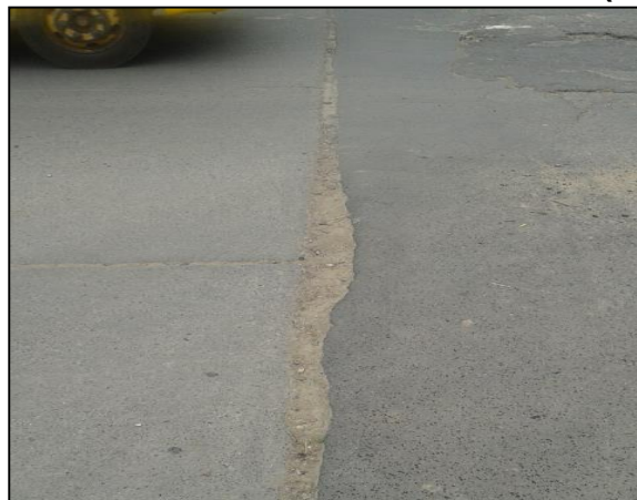
Figura 7. Fisura Transversal en Junta de Construcción (FCT)
