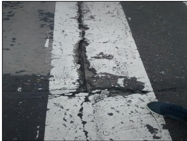
Figura 6. Fisura Longitudinal en Junta de Construcción (FCL)
