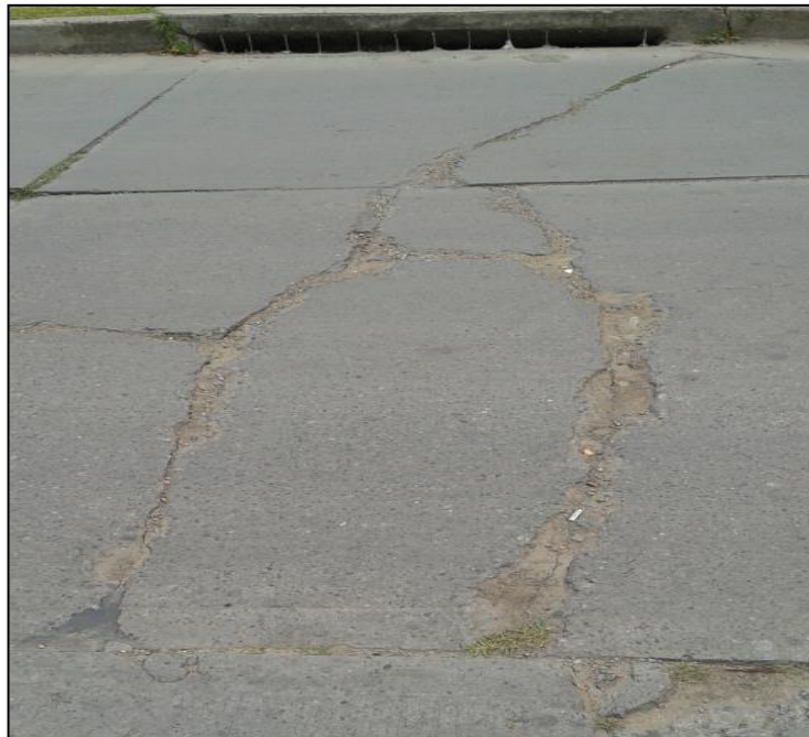
Figura 31. Grietas en Bloque o Fracturación Múltiple (GB)
