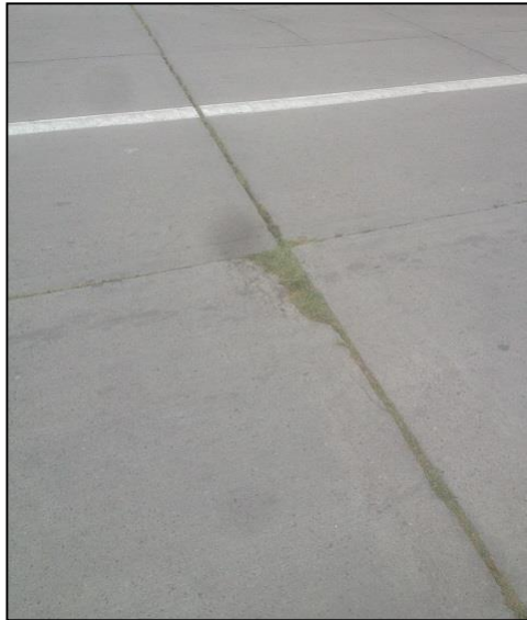
Figura 34. Desportillamiento de Juntas (DPT y DPL)
