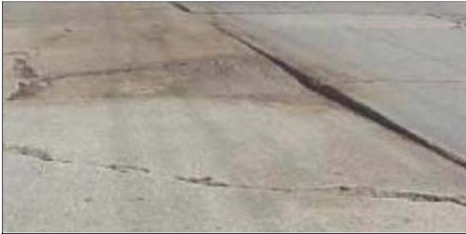
Figura 41. Hundimientos o Asentamientos (HU)
