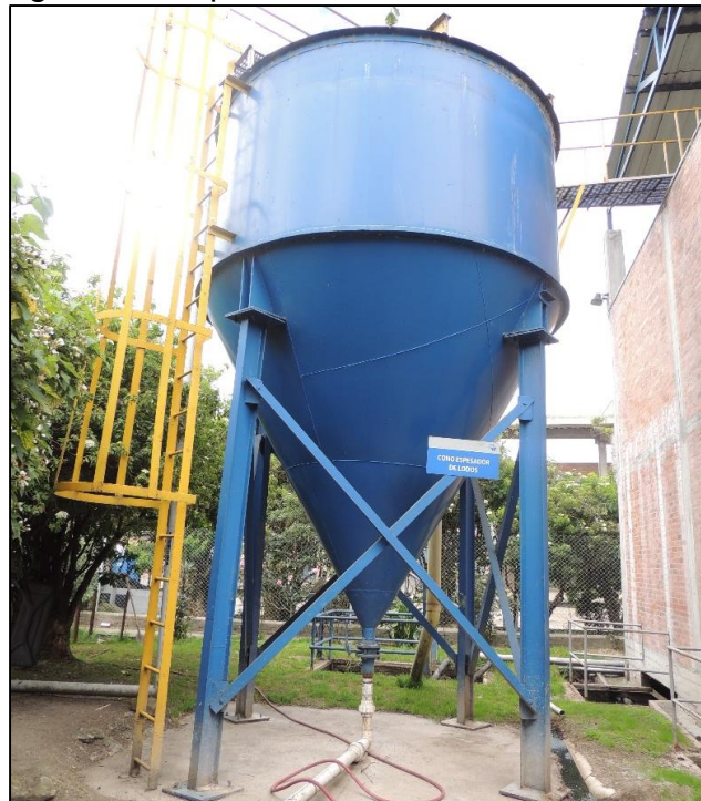
Figura 15. Espesador de lodos
