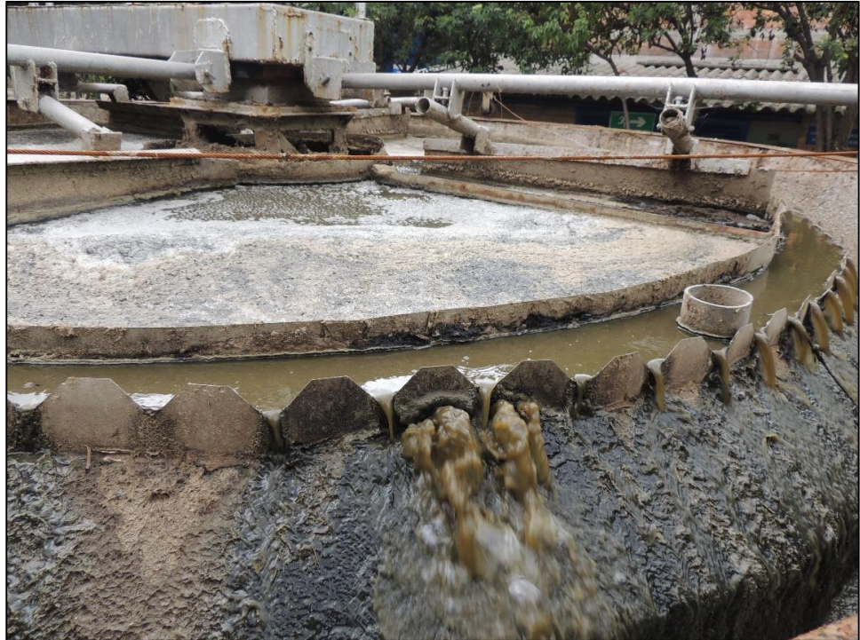
Figura 11. Unidad DAF vista lateralmente
