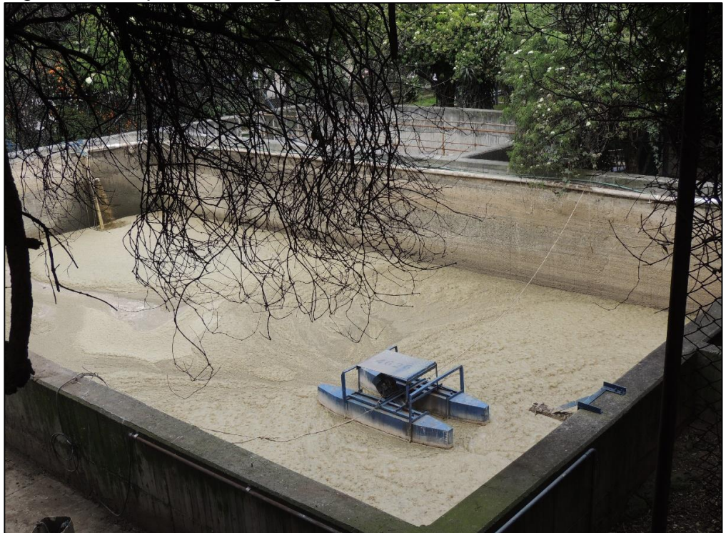
Figura 7. Tanque de homogenización
