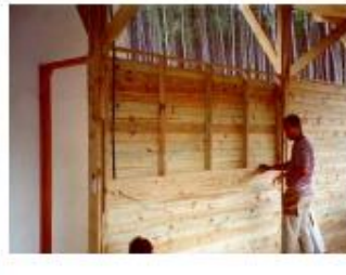
6. Fechamento – execução das ossaturas dos pinéis in loco e fixação dos lambris de parede (2.2x10 cm).
