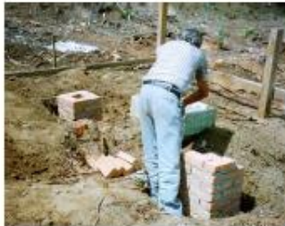
1. Fundação tipo sapata isolada -execução do furo de 50x50x80 cm; do lastro de concreto (5 cm) e do pilarete em alvenaria (5x10x20 cm) .
