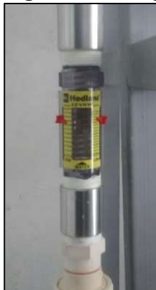
Figura 12. Flujómetro Banco Hidráulico
