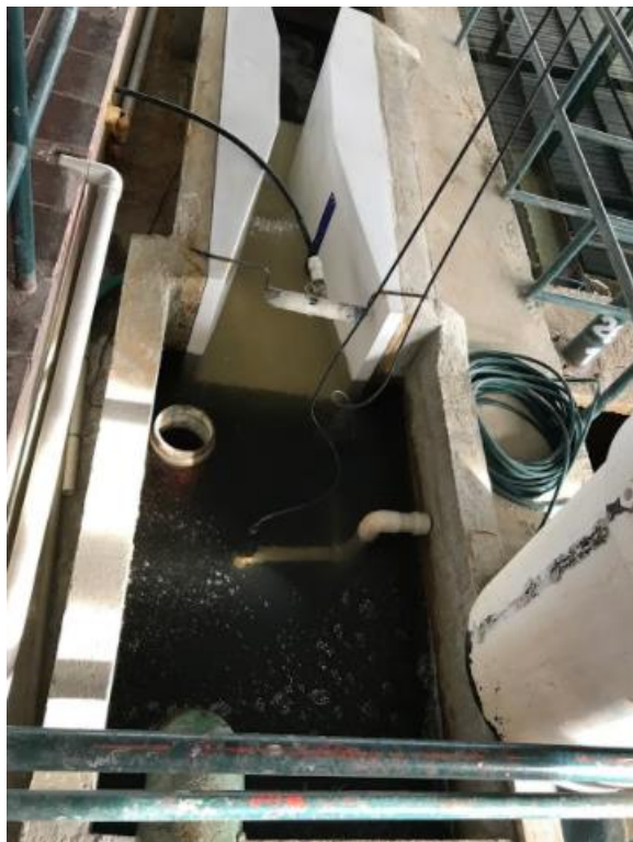
Ilustración 5. Canaleta Parshall PTAP Municipio de Sibaté
