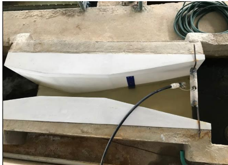
Ilustración 4. Canaleta Parshall PTAP Municipio de Sibaté
