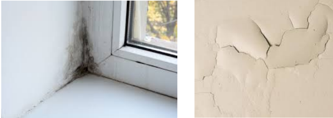
Imagen 6. Consecuencias de la humedad en el concreto
