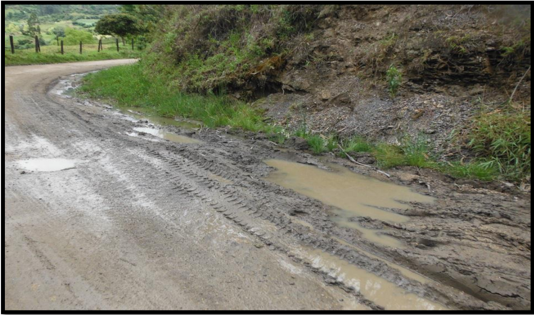
Figura 7: Deterioro de la vía existente debido a las lluvias. Fuente: Propia.
