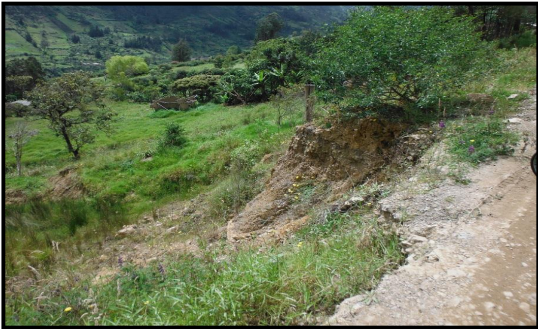
Figura 9: Perdida de la banca de la vía.
