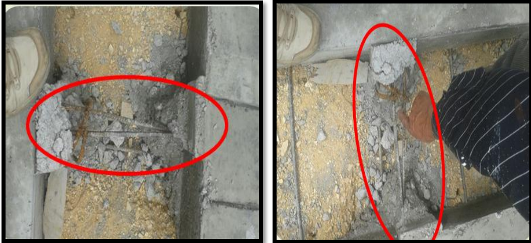
Figura 40 y Figura 41: Falta de estribos en la viga riostra del tramo 3.
