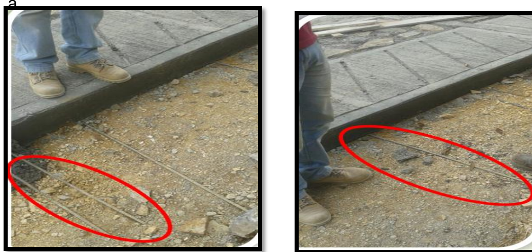
Figura 42 y Figura 43: Falta de recubrimiento del acero en el tramo 3.
