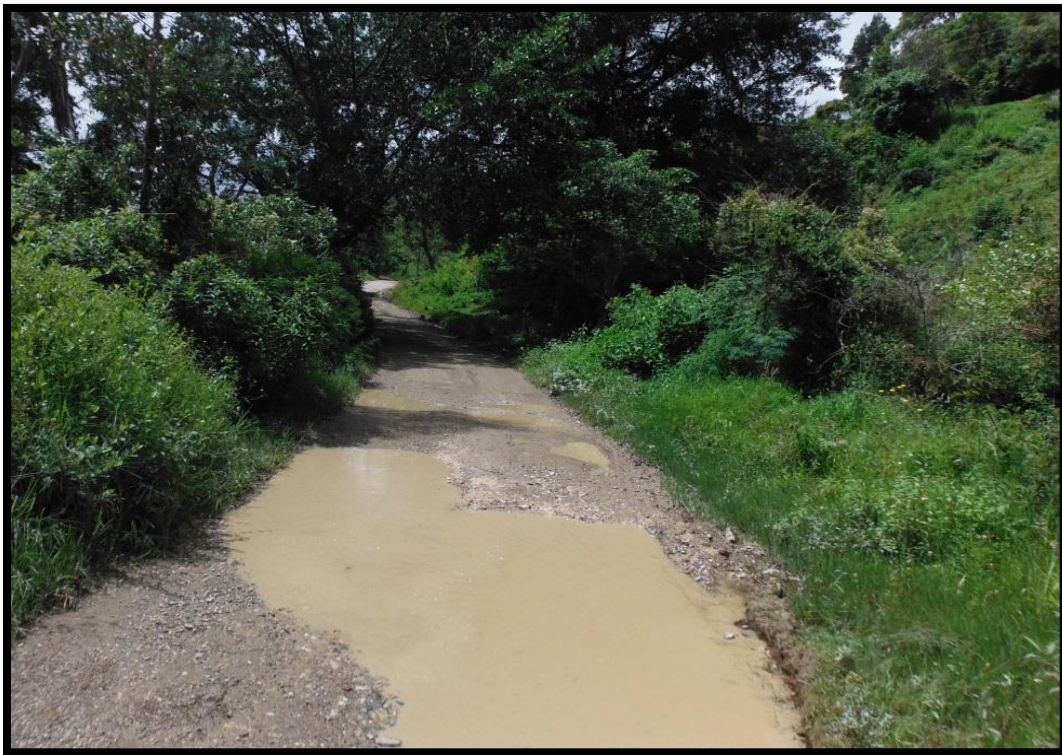
Figura 6: Estado de la vía Casadillas Alto después de la ola invernal. Fuente: Propia
