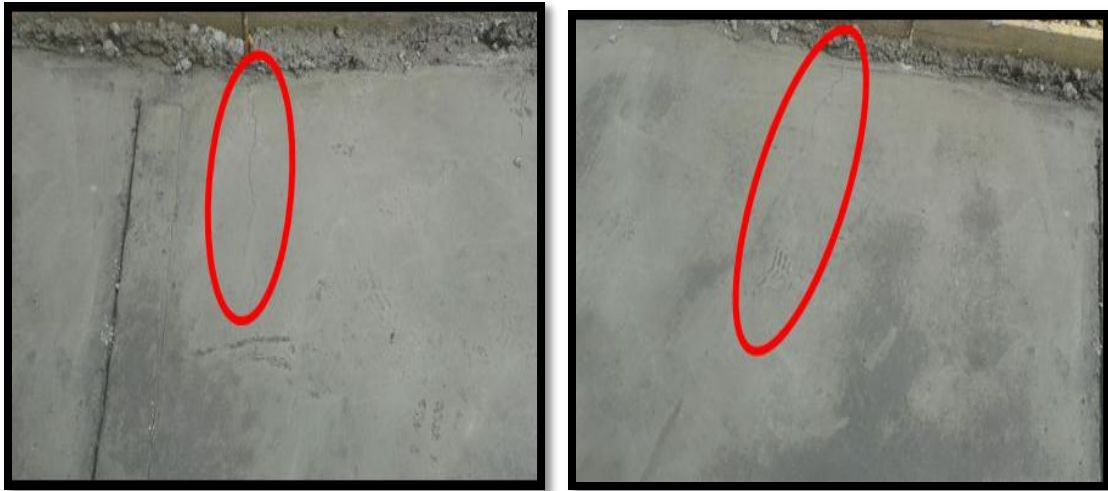
Figura 44 y Figura 45: Fisuras en cunetas del tramo 3.
