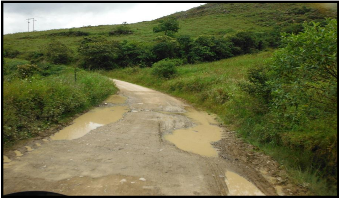
Figura 8: Empozamiento de aguas lluvias. Fuente: Propia
