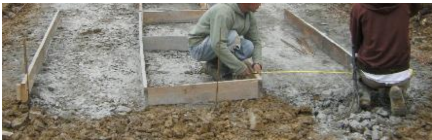
Colocación de las formaletas sobre la superficie acondicionada para la placa huella
