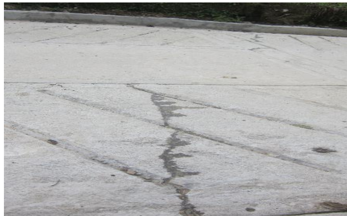
Figura 71. Agrietamiento prematuro de la placa huella del tramo 1
