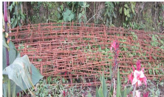
Disposición de acero a la intemperie sobre materia vegetal, sin ninguna protección, o almacenamiento adecuado
