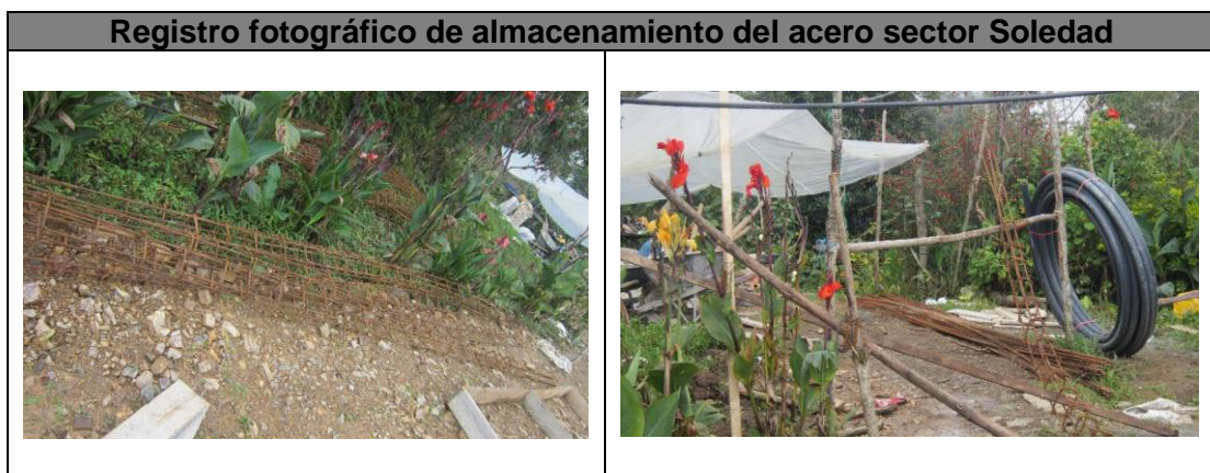
Figura 86. Almacenamiento de barras de acero en el sector Soledad
