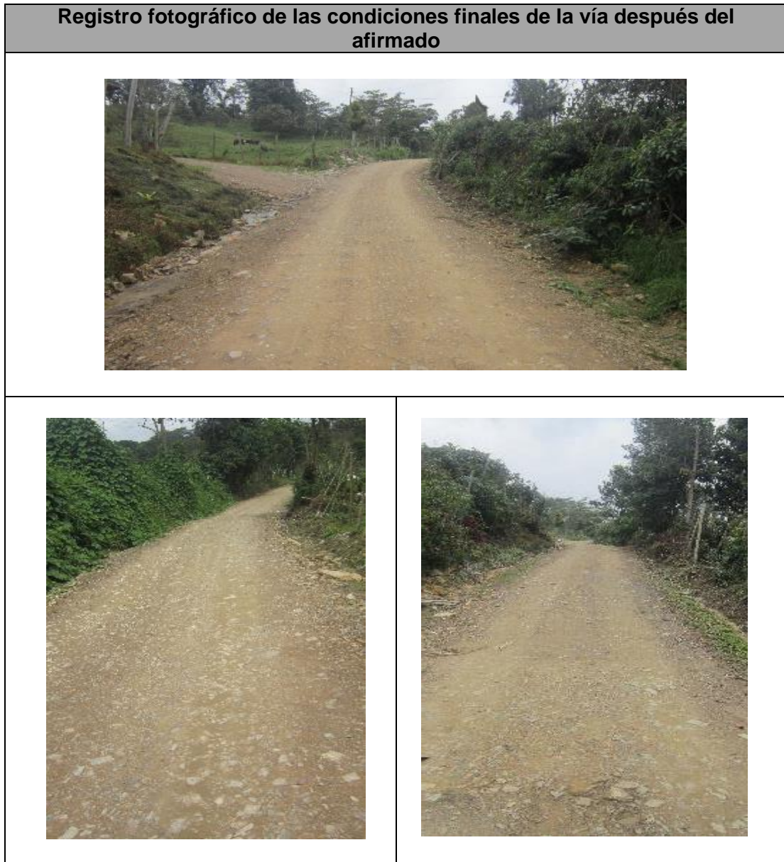
Figura 46. Condición final de la vía en varios tramos de ésta
