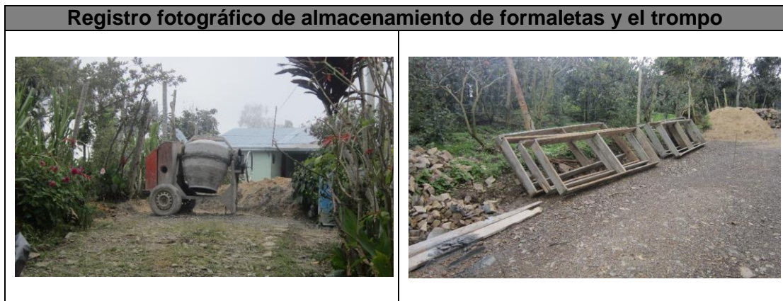
Figura 88. Almacenamiento de mezcladora tipo trompo y formaletas en predios cercanos y borde de carretera en el sector Soledad
