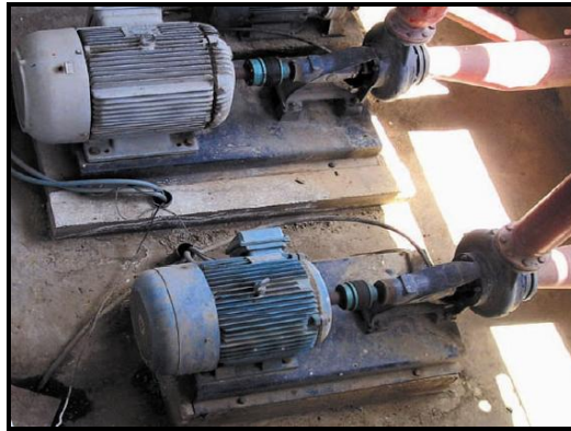
Figura 2. Motobombas instaladas en paralelo (Liotta 2005).
