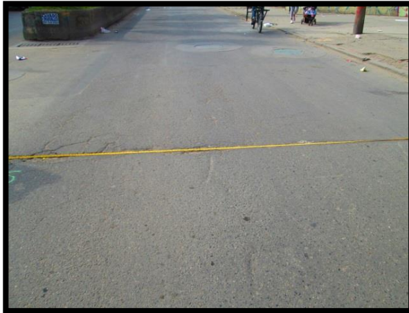
Figura 5. Fisuras Transversales Fuente: Propia
