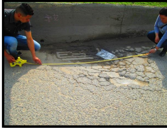
Figura 8. Hundimiento. Fuente: Propia
