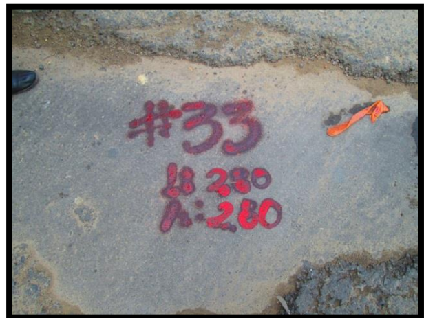
Figura 8. Descascaramiento Fuente: Propia
