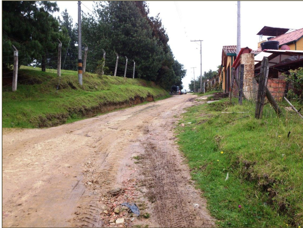
Figura. 2 Estado Inicial de la vía. Longitud 246m ancho aproximado 4.0m K0+054 al K0+300.
