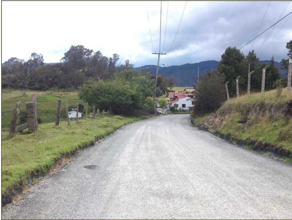
Figura. 17 Vía terminada con el sistema Probase Road System, longitud aprox. 246.0m, ancho aprox. 5.0m. K0+054 al K0+300
