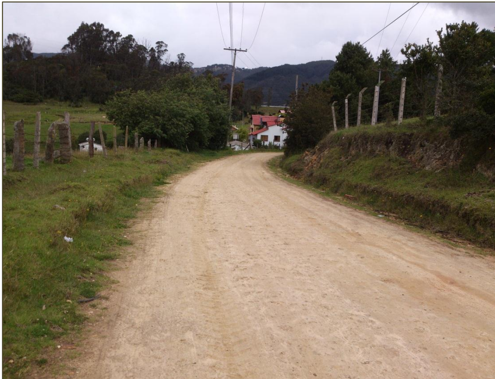
Figura. 1 Estado Inicial de la vía. K0+054 al K0+300.
