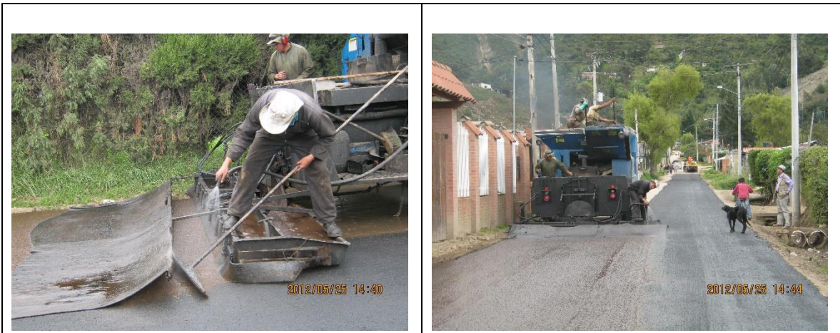
Imagen: 9. Proceso de extendido e instalación del micropavimento, Se coloca el micropavimento o Slurry sobre las vías estabilizadas, interviniendo un carril a la vez, previamente se realizan tramos de prueba en vía para verificar el comportamiento de micropavimento. (slurry seal). Fuente: consorcio intervias 2012, Contrato No 388 2011.
