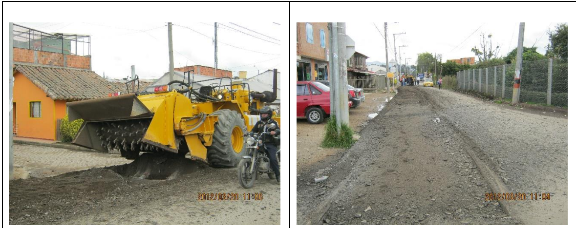
Imagen: 6. Se realiza conformación y afirmado de la vía, en algunos casos es necesario realizar intervenciones a profundidad con el fin de garantizar la el soporte de la estructura.
