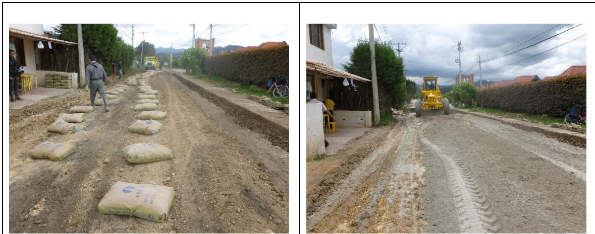
Imagen: 7. Se hace la reconfiguración y/o mejoramiento de la subrasante existente con cemento o emulsiones asfálticas, (multienzimas) en las vías donde es necesario aumentar la capacidad portante de la sub-rasante, o capas granulares.
