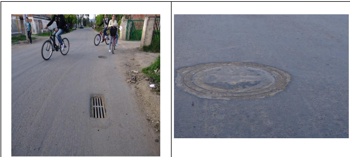
Imagen: 13. Detalle de protección estructuras de desagüe.
