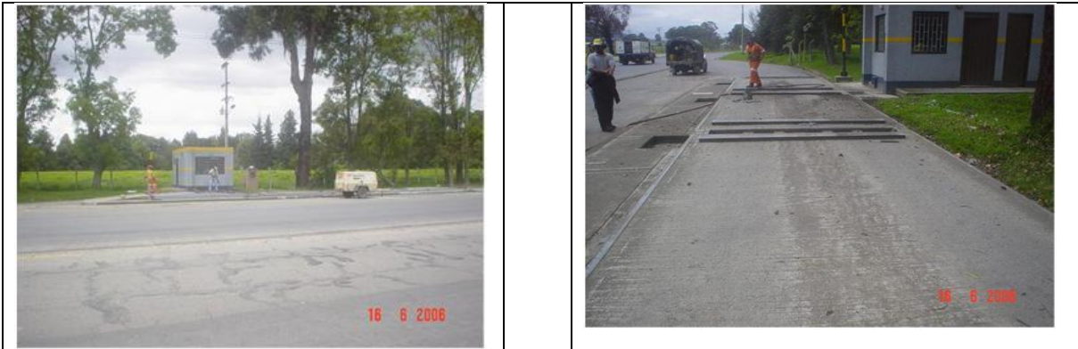
Figuras No. 24 y 25 Fallas presentadas en vigas soporte de plataformas
