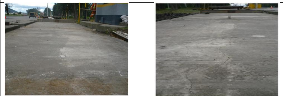
Figuras No. 28 y 29 Obsérvese grieta longitudinal sobre placa de soporte de las plataformas.
