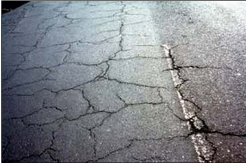
Figura 42. Fisuras en bloque. Fuente archivo personal de los autores).
