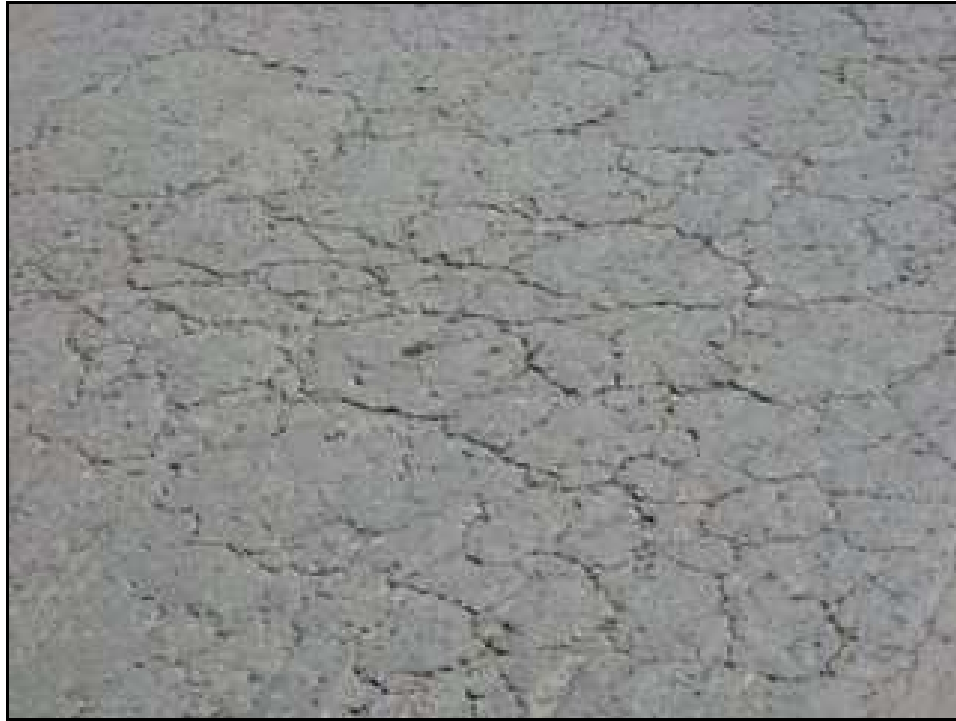
Figura 41. Piel de cocodrilo en el pavimento. Fuente archivo personal de los autores).
