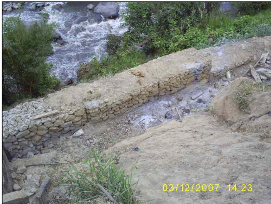
Figura 36. Obras complementarias, estabilización de laderas y protección del cauce de un río con muros de gaviones. (Fuente archivo personal de los autores).
