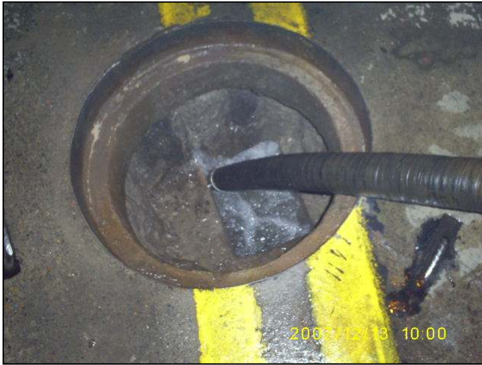
Figura 4. Mantenimiento rutinario. Lavado ducto central de drenaje de un túnel vial, la tubería se purga inyectando agua a alta presión. (Fuente archivo personal de los autores).
