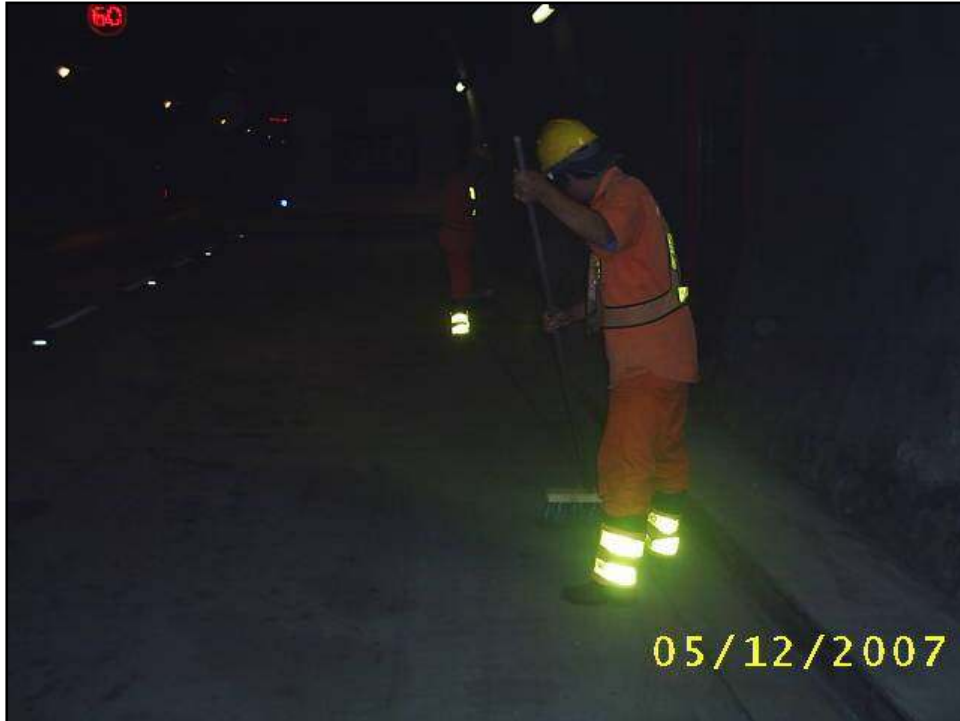
Figura 3. Mantenimiento rutinario. Barrido de la calzada de la vía dentro de un túnel. (Fuente archivo personal de los autores).
