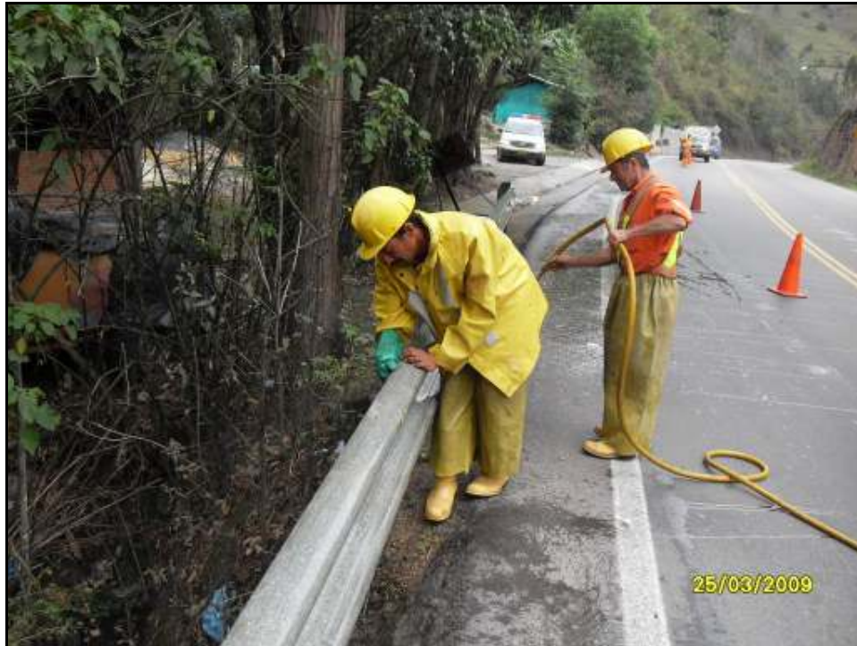
Figura 16. Mantenimiento rutinario. Lavado defensas metálicas. Nótese la ubicación de la señalización preventiva. (Fuente archivo personal de los autores).
