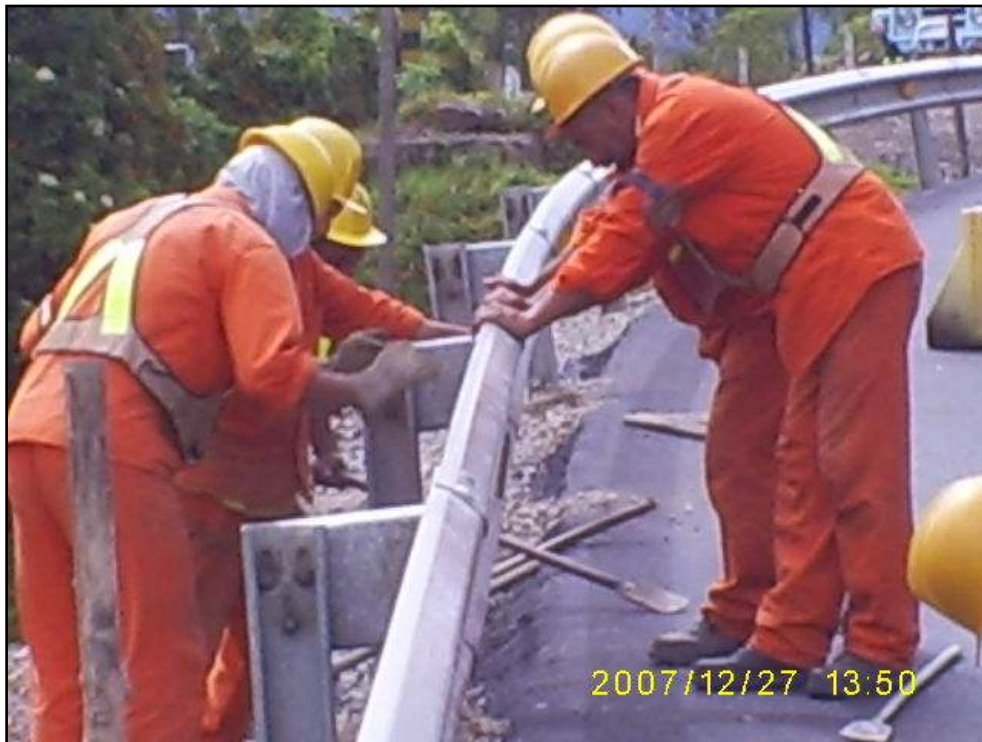
Figura 26. Mantenimiento según auscultación defensas metálicas. (Fuente archivo personal de los autores).
