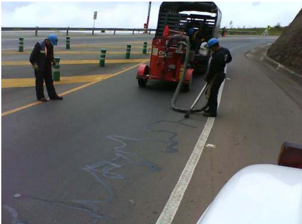
Figura 14. Mantenimiento rutinario. Sello de grietas en el pavimento. (Fuente archivo personal de los autores).
