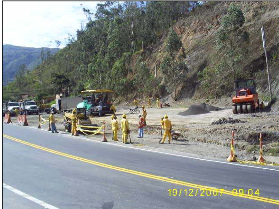
Figura 37. Obras complementarias, estabilización de taludes por medio de descargas de material y terracéo. (Fuente archivo personal de los autores).
