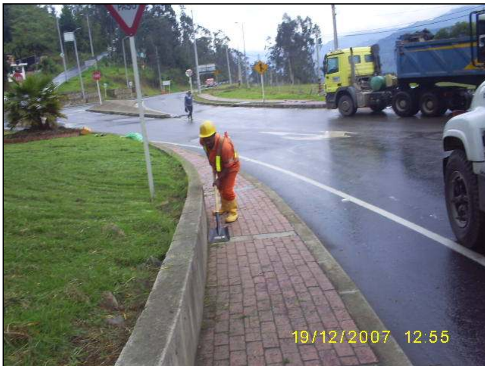
Figura 7. Mantenimiento rutinario. Limpieza de cunetas y bermas (Fuente archivo personal de los autores).
