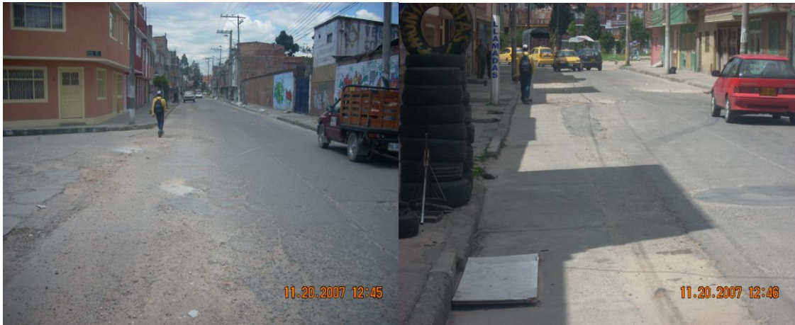
Evidencia de fatiga de la carpeta asfáltica con fisuras longitudinales y trasversales.
