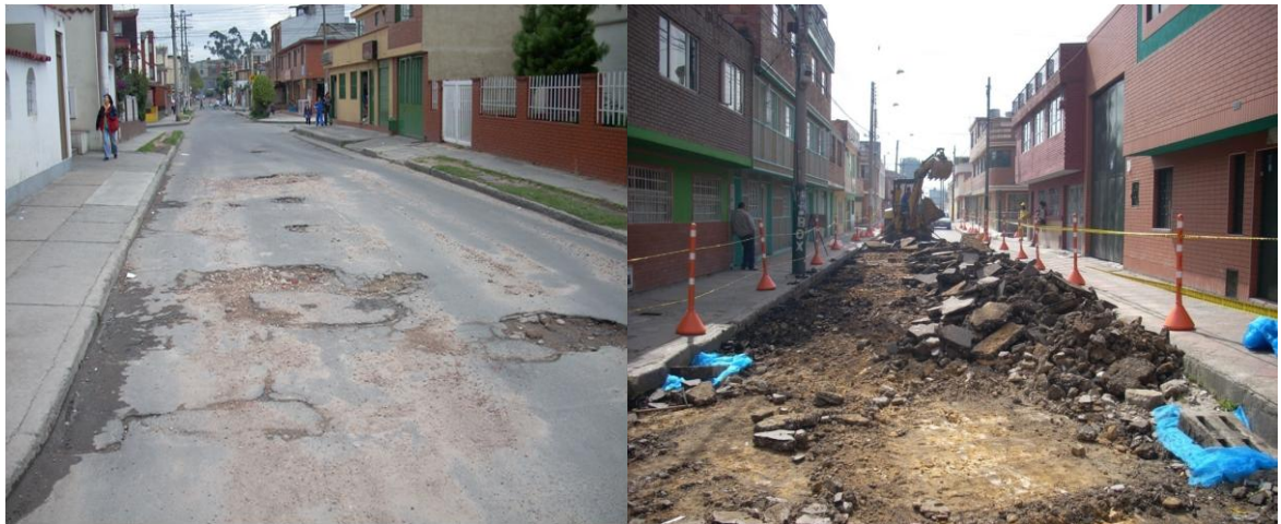
Izq. Evidencia de ojos de pescado con pérdida de trozos de carpeta que ocasionan pérdida de aridos afectando la estructura del pavimento. Der. Levantamiento y retiro de carpeta asfáltica con parte de la estructura (base).
