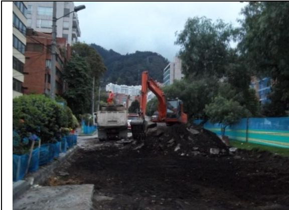
Fotografía 11. La subrasante es totalmente tierra negra
