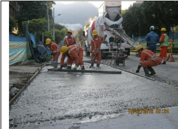
Fotografía 22 .No utilización de regla para concreto
