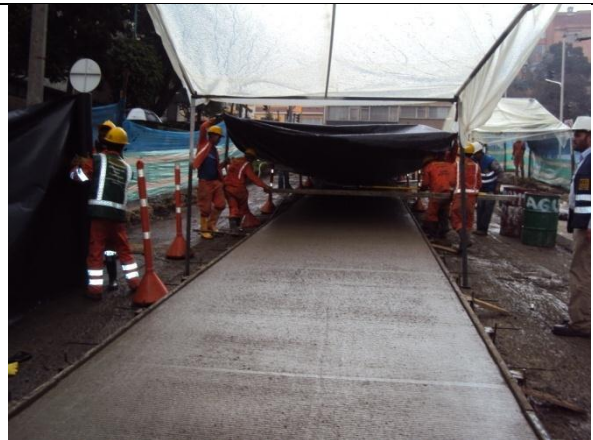
Fotografía 30. Protección del concreto por causa del agua
