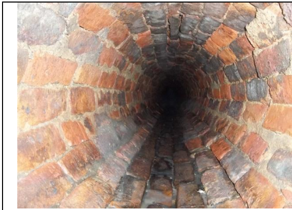
Fotografía 35. Colector antes de la nueva tecnología
