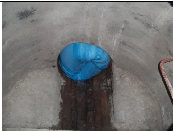
Fotografía 40. Manga saliendo al pozo de inspección
