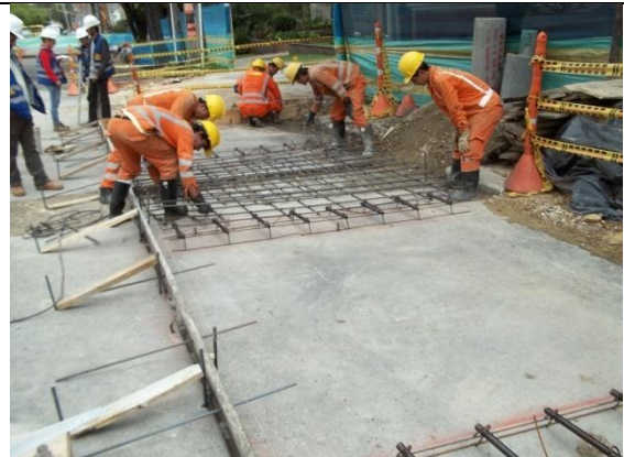
Fotografía 23 .Formaleta no adecuada para el concreto
