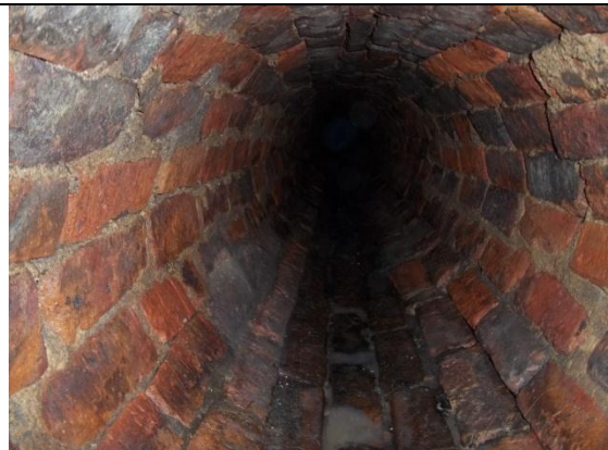
Fotografía 36. Colector con fisuras y fugas
