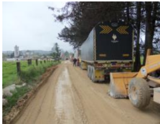
Tracto mulas en el corredor intervenido lo cual dificulta las labores de extendido y compactación del material, teniendo en cuenta el espacio reducido para maniobrar con las maquinas.
