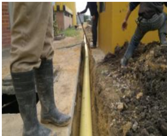
Instalación de tubería de 8" pulgadas Novafort para drenar las aguas lluvias que llegan al tramo a construirse.
