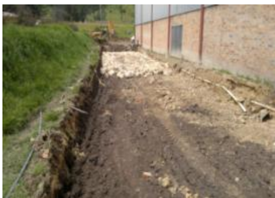
Excavación para arreglo de acceso a las oficinas de la bodega, así como el primer tramo de rajón instalado.
