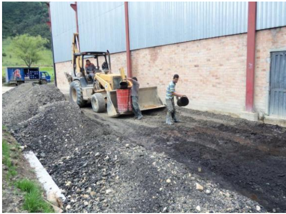
Transporte y disposición del RAP, se debe descargar en forma de cordón.
