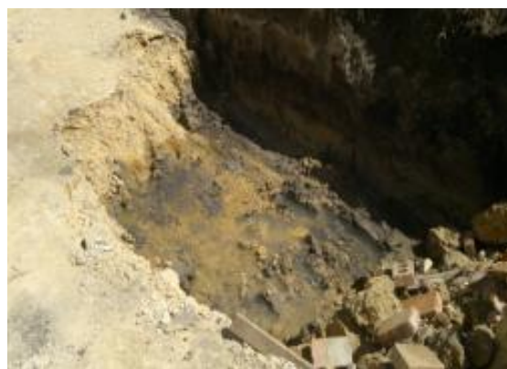
Excavación para reparar fallo evidenciado luego de someter a carga el tramo. Se presenta nivel freático (agua que permanece de manera constante).
