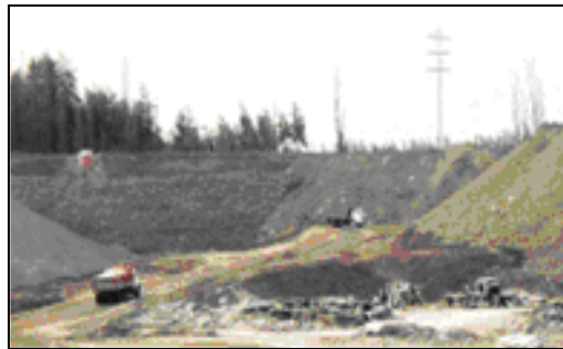
Extracción desde pozos seco
