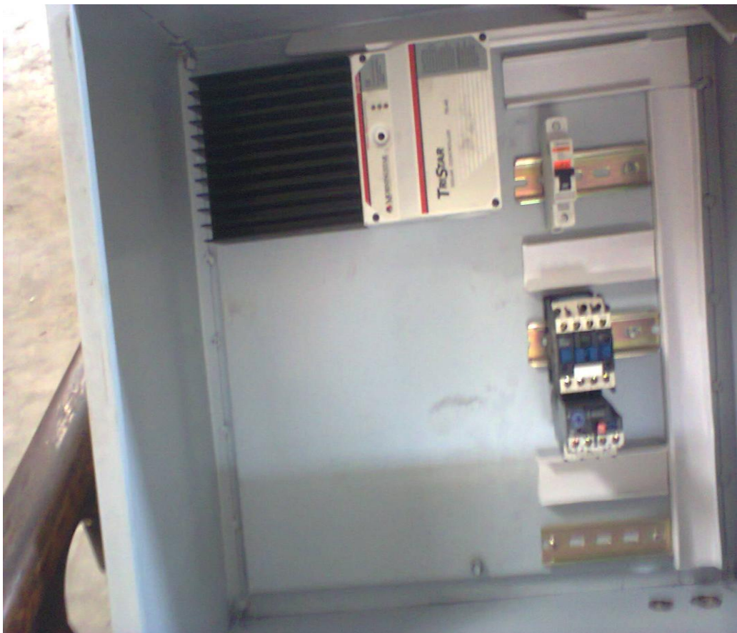
Componentes del sistema solar fotovoltaico
