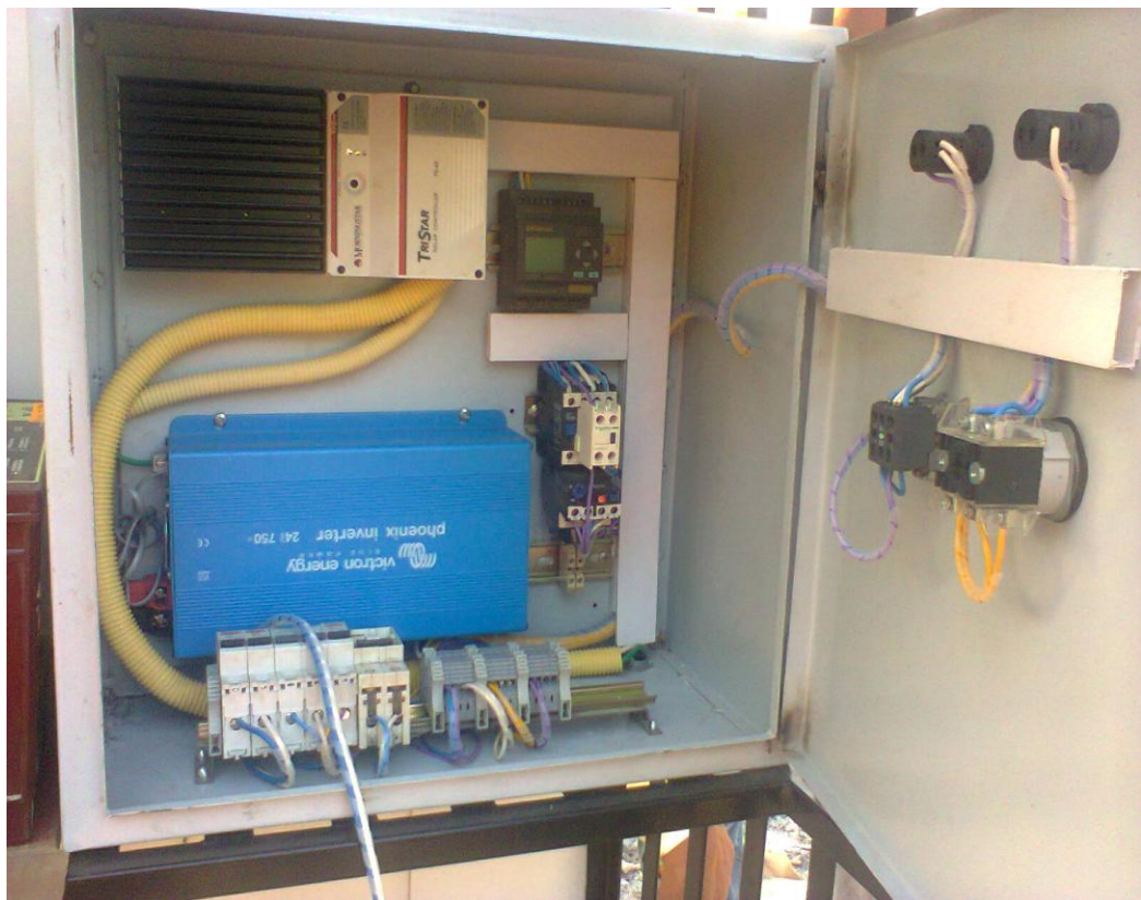
Sistema de control automatizado
