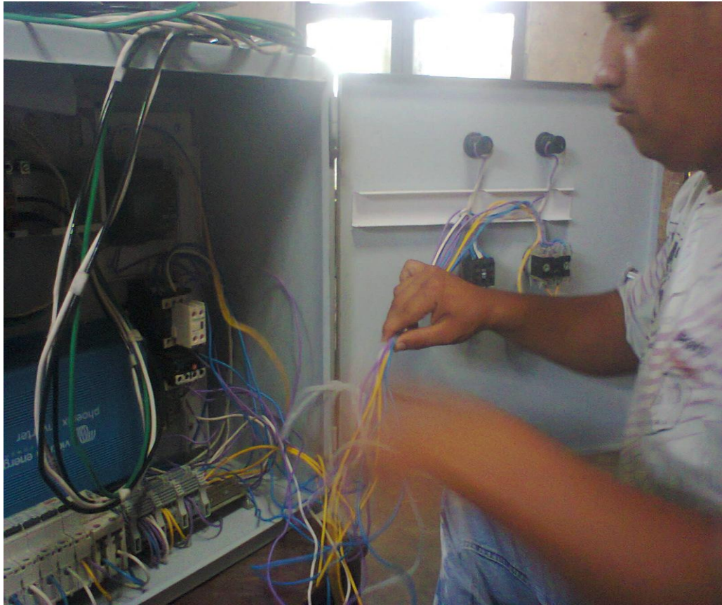
Cableado eléctrico del sistema automatizado
