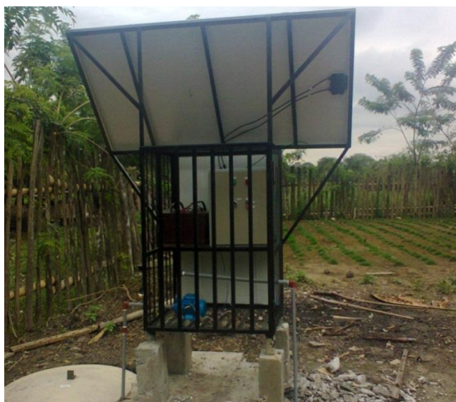
Figura 6. Sistema solar fotovoltaico.
