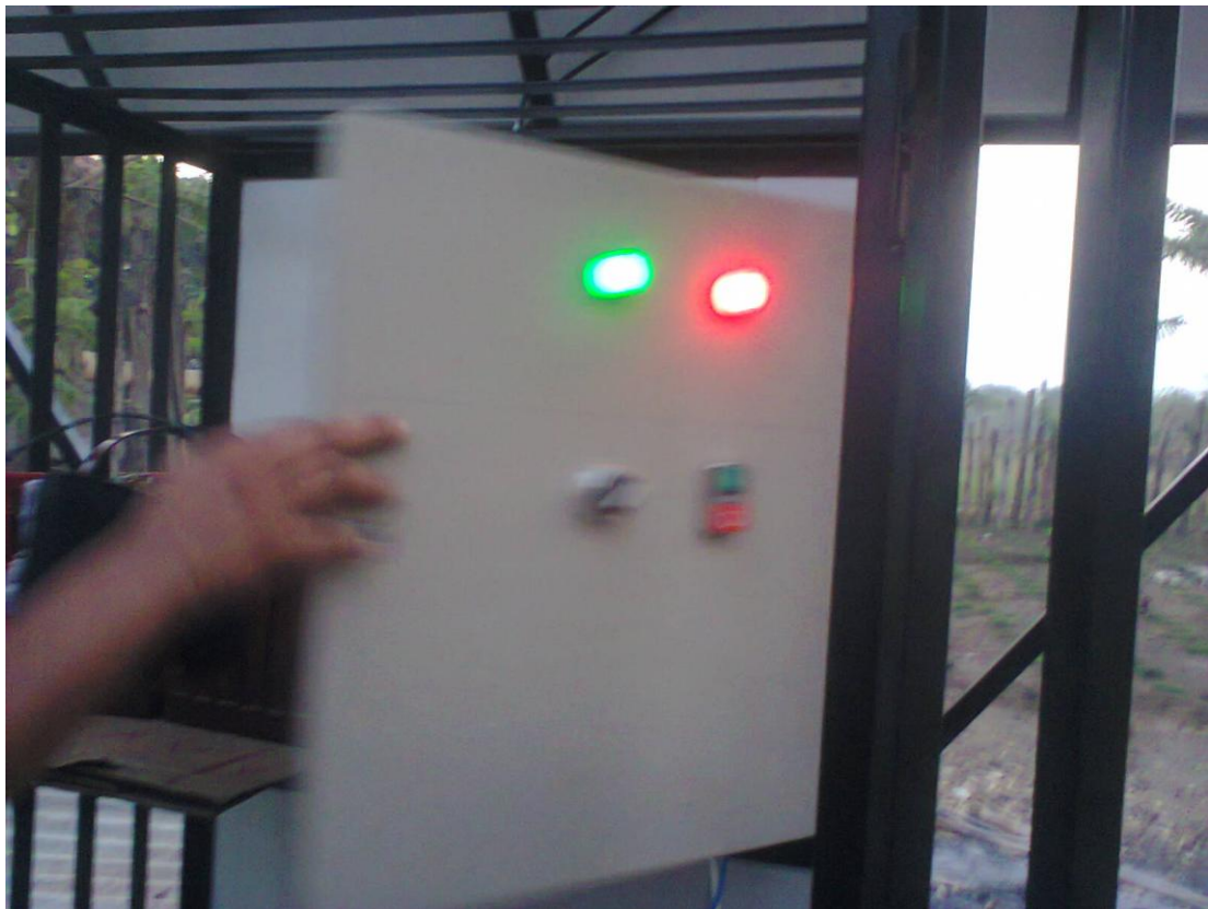
Prueba de funcionamiento del sistema automatizado
