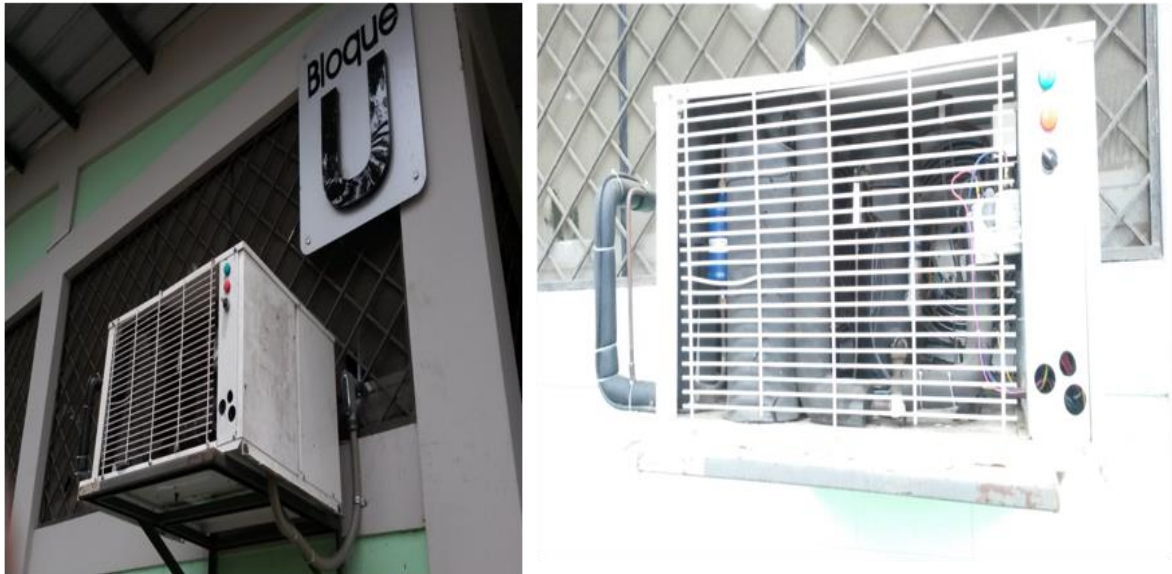
Figura 16. Unidad condensadora instalada en la UNEMI
