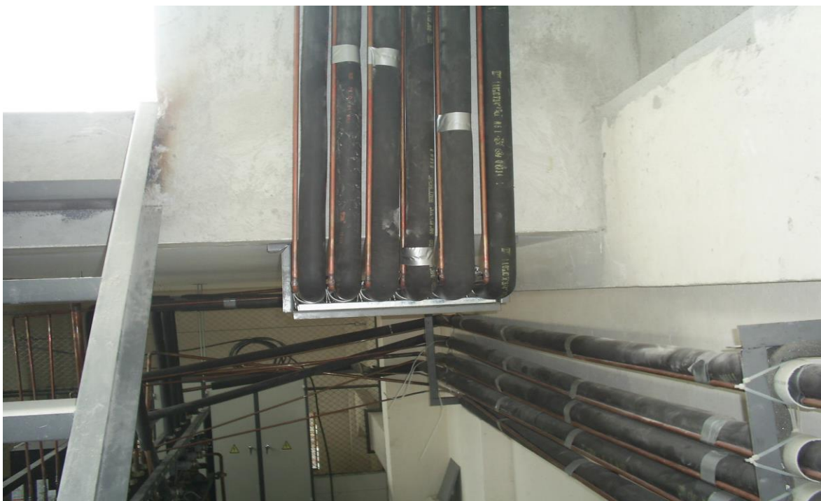
.Figura 7. Instalación típica de la tubería de refrigeración (Supermercado de carnes Orellana)
