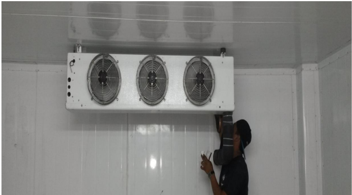
Figura 6. Unidad evaporadora instalada en cámara frigorífica UNEMI
