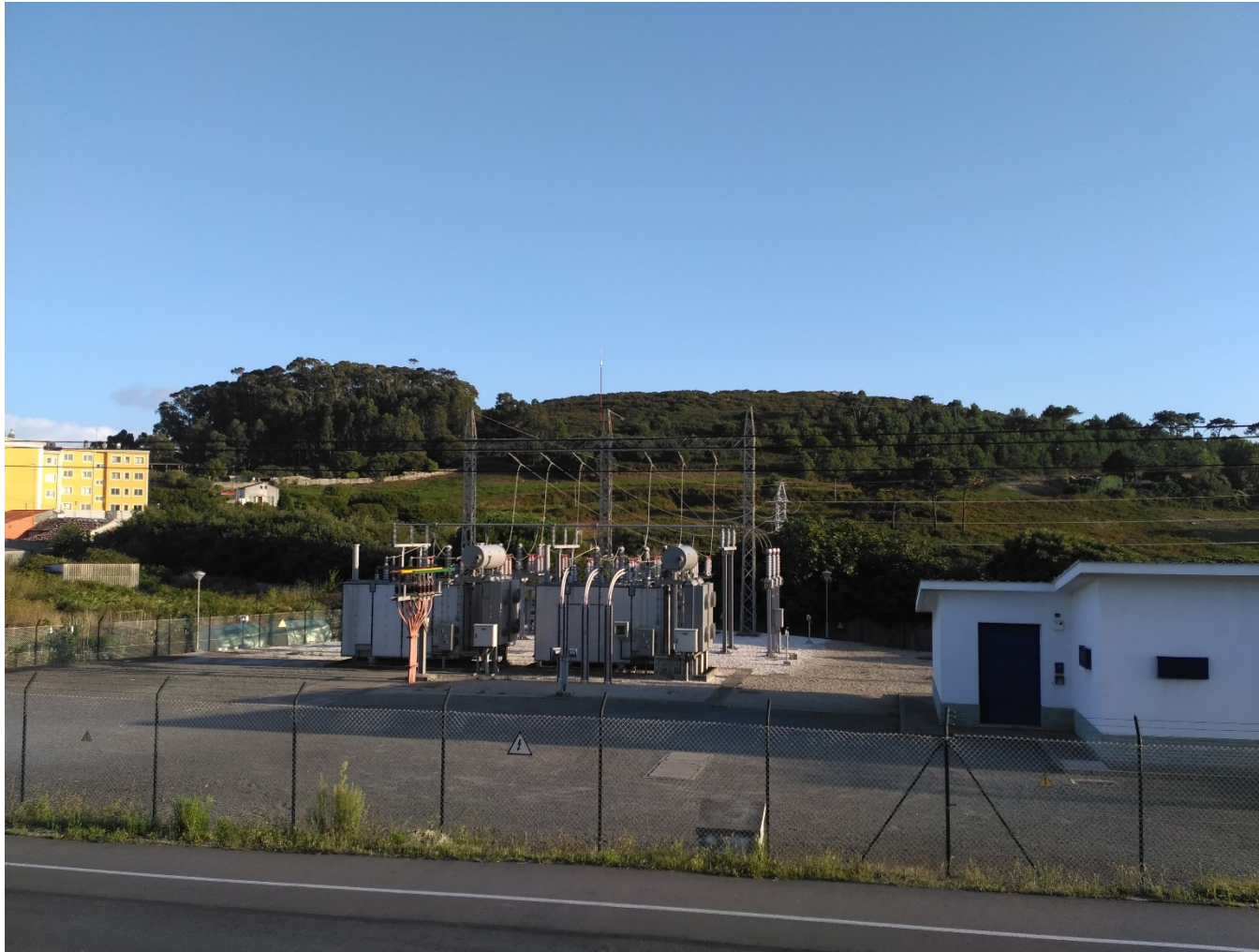
Fotografía 3: Transformadores de fenosa
