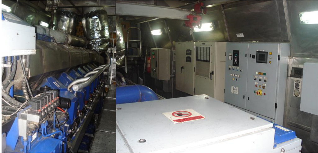
Figura 4.2.1.2. Vista de la sala de máquinas del buque catamarán.
