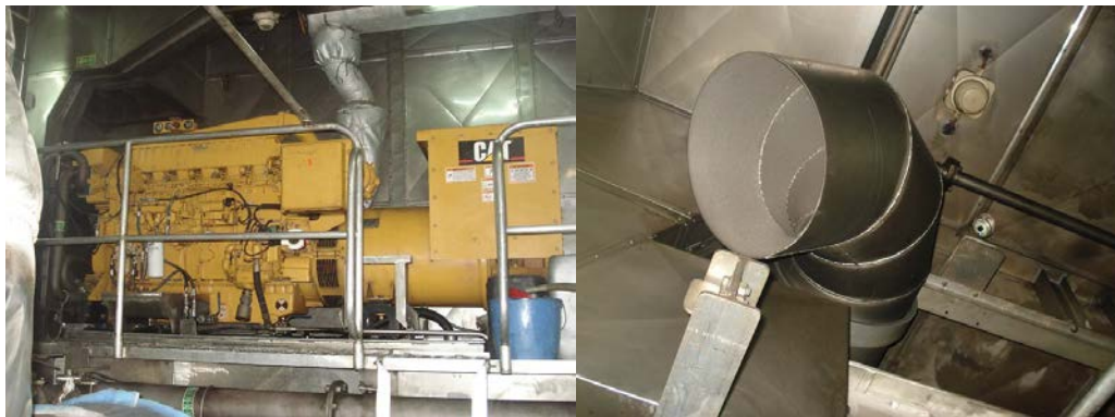
Figura 4.2.1.3. Vista del generador y del conducto de ventilación de la sala de máquinas del buque catamarán.
