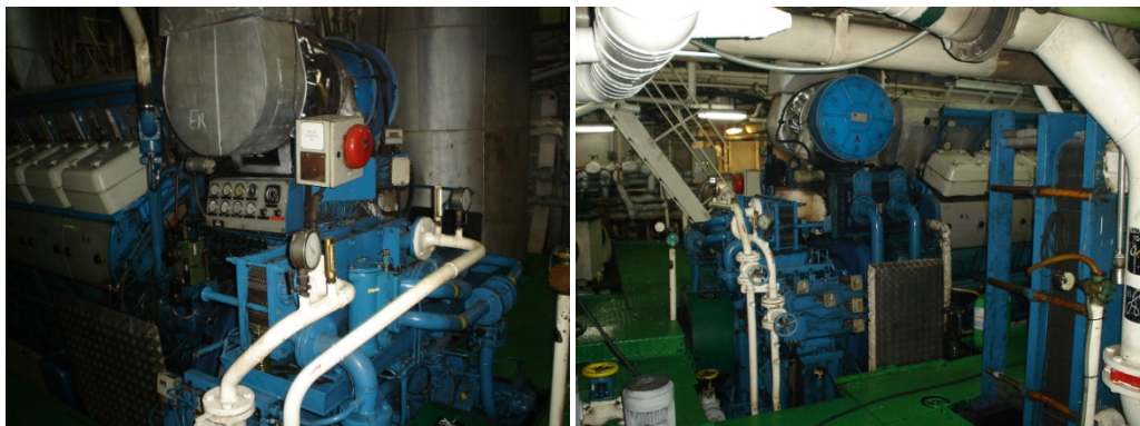
Figura 4.2.1.14. Sala de motores propulsores del buque ropax.
