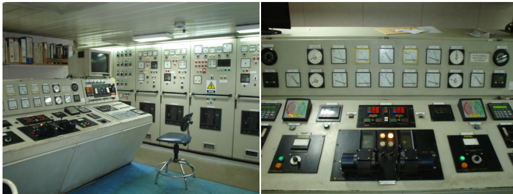
Figura 4.2.1.15. Control de máquinas del buque ropax.
