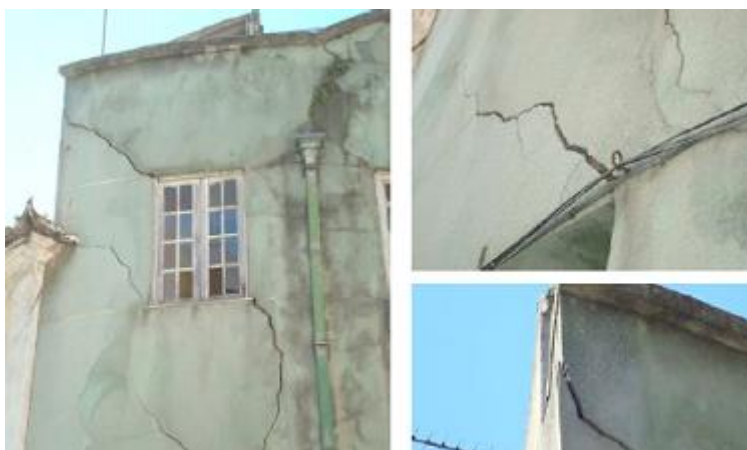
Figura 3.31 - Fendilhação de parede [84].
