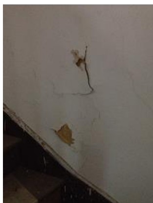
Figura 3.44 - Empolamento de reboco em parede interior.
