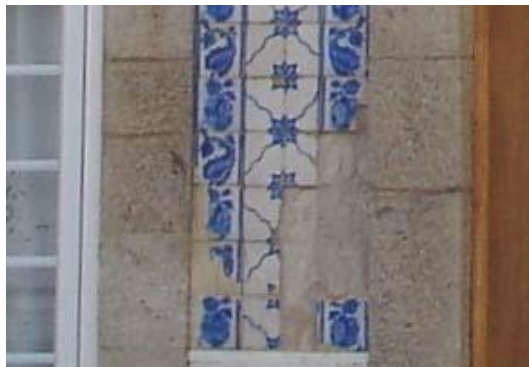
Figura 3.42 - Perda de azulejos em revestimento exterior.
