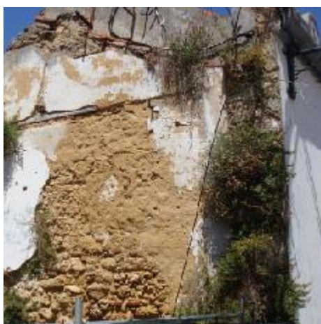
Figura 3.32 - Desagregação da alvenaria [86].
