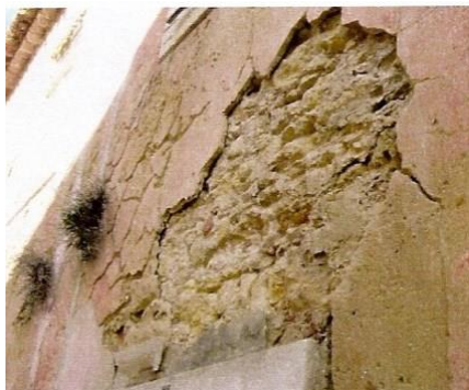
Figura 3.40 - Revestimento com perda de aderência [100].
