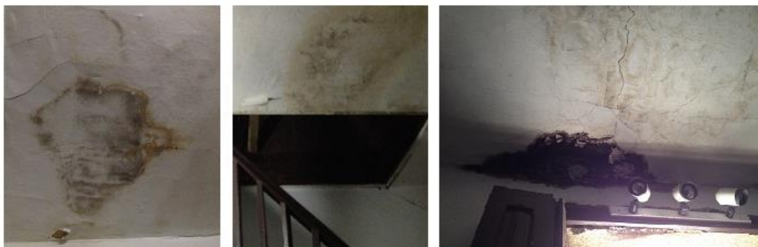
Figura 3.33 - Infiltrações no pavimento por humidade de precipitação.
