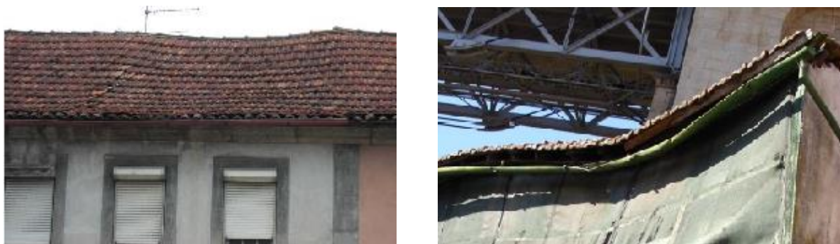
Figura 3.37 - Estrutura de cobertura com deformação excessiva [55] [71].
