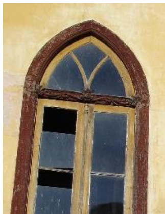
Figura 3.43 - Caixilharia com madeira deteriorada e vidros danificados [55].
