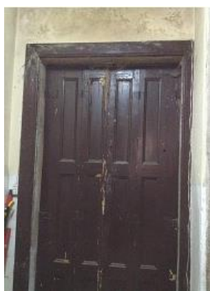
a) Porta interior degradada.
