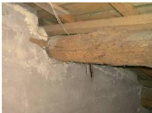
a) Viga cobertura atacada por podridão branca.
