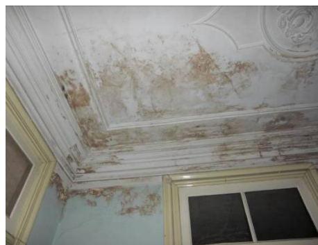
b) Manchas por umidade de infiltração.
