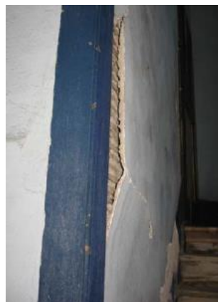
b) Empolamento de reboco [84].
