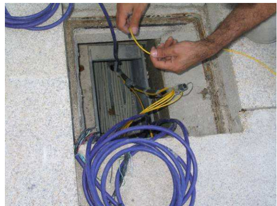
Fig 19- Caixa de visita e de acesso à calha técnica
