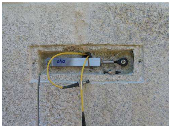
Fig 9- Instrumentação de juntas. Transdutor de deslocamento de fibra óptica.
