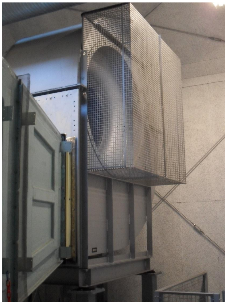
Fig. 56 – Ventilador instalado no INEGI.
