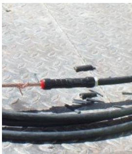
Figura 3.11 - União entre Cabo de Cobre VV 35mm 2 e Cabo de Alumínio 70mm 2
