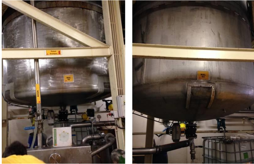
Figura 11 - Equipamentos “MAL02” e “MAL03”
