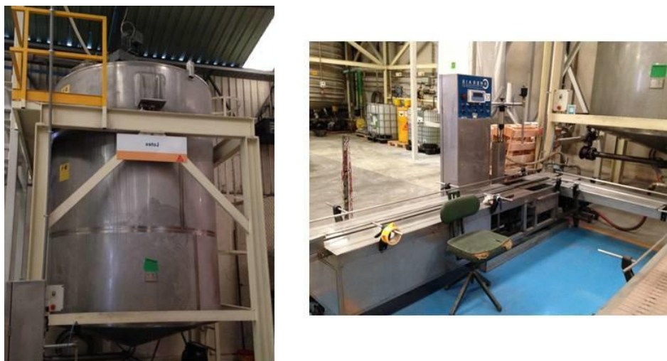
Figura 13 - Equipamento "Latex" e mesa de enchimento
