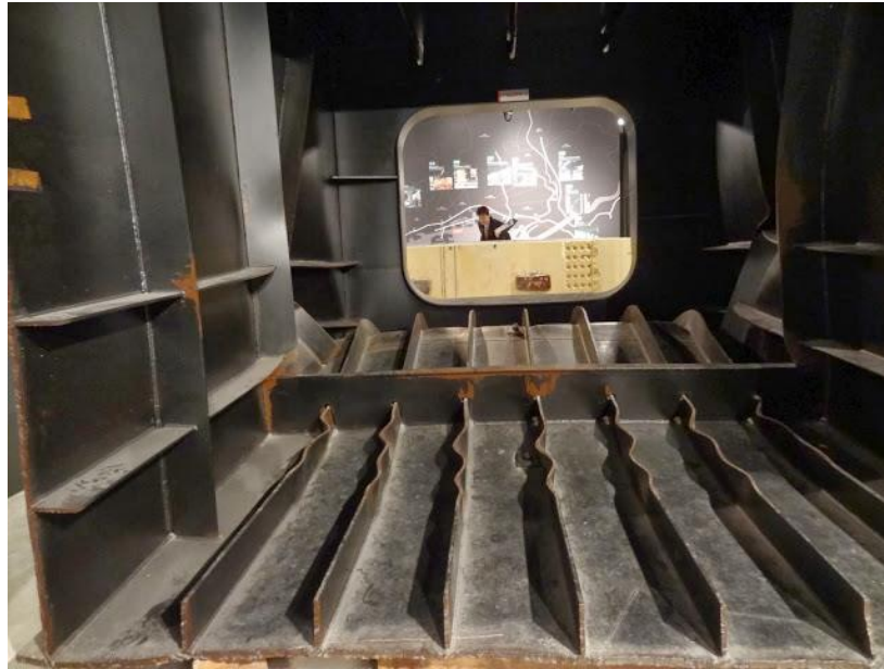
Fig. 2.20 – Vista interior de um caixão com encurvadura do banzo inferior
