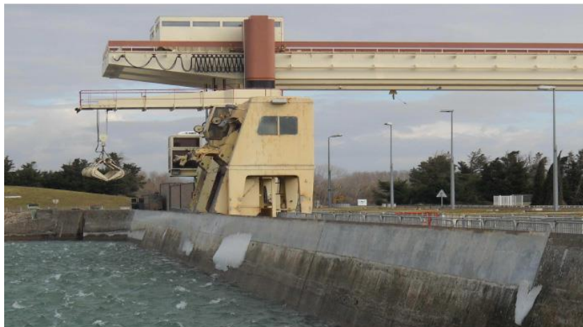
Figura 2.16 Baragem de Caderousse, no rio Rhone em França, após as obras de reparação com UHPFRC, visíveis a cinzento claro [65].
