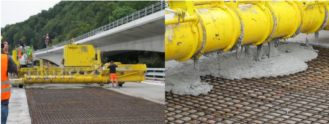
Figura 2.10 Reforço e impermeabilização da laje de um dos viadutos de Chillon, na Suíça [33].
