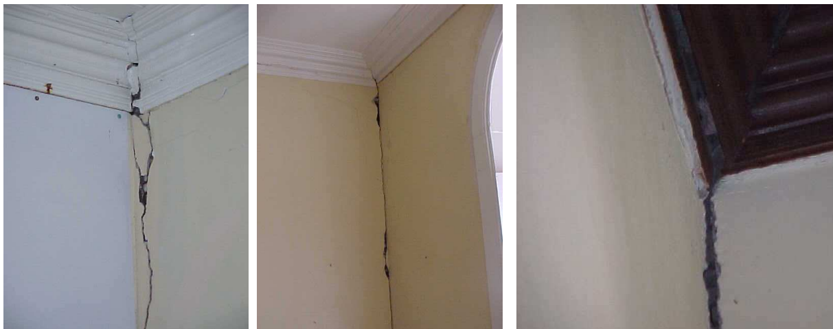
Figura 5 – Fissuras na ligação das paredes interiores às exteriores
