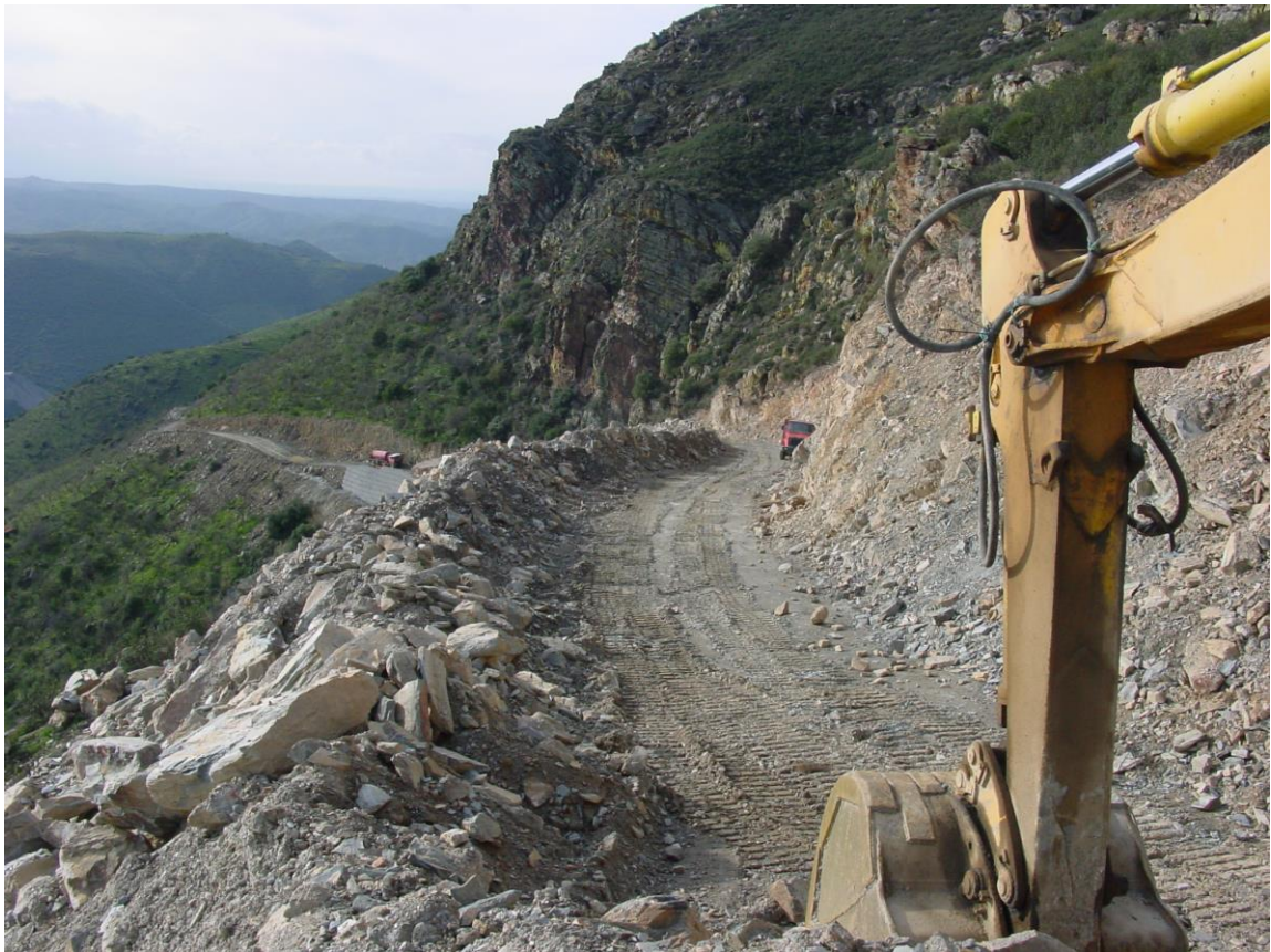
Foto nº 5 – Vista sobre a estrada imediatamente acima do tramo de maior declive. É possível ver a máquina rectro-escavadora de escavação e movimentação de rocha e terra. Ao fundo é possível observar parte do muro de contenção das terras de aterro.
