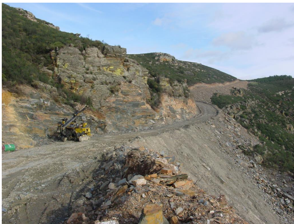
Foto nº 4 – Zona mais elevada do traçado da estrada onde é visível uma máquina de perfuração (Roc – Atlas Copco) para abertura de furos tendo em vista o arranque de rocha com explosivos .
