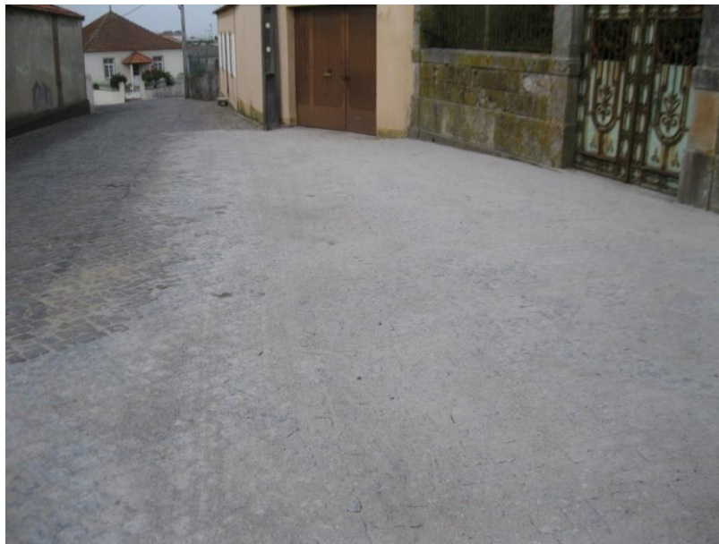
Figura 2.6 - Pequena pavimentação na freguesia de Estela com betumagem a pó de pedra.
