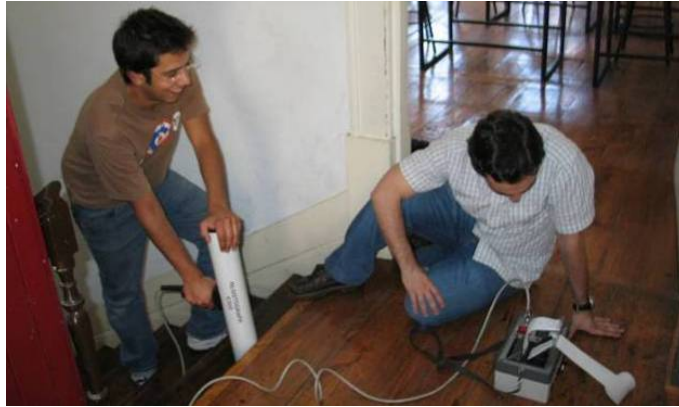
Figura 9. Utilização do Resistograph para avaliação da integridade de elementos estruturais de escadas de madeira, Edifício São Domingos, séc. XIX (1856), Porto.
