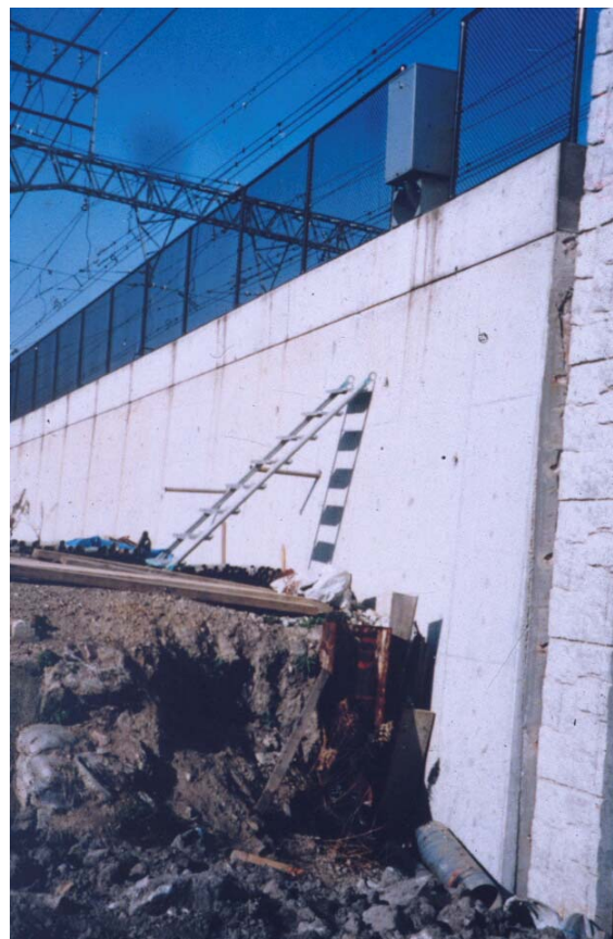
Figura 5 – Deslocamentos sofridos pelo muro de betão armado localizado no lado oposto da “box culvert” ([3])
