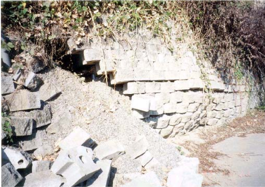
Figura 6 – Rotura ocorrida num muro com face modular durante o sismo de Chi-Chi em Taiwan, 1999 [4]
