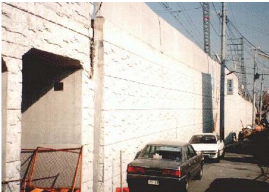
Figura 3 – Deslocamentos sofridos pelo muro reforçado com geogrelhas localizado em Tanata após o sismo de Kobe, 1995 ([4]).
