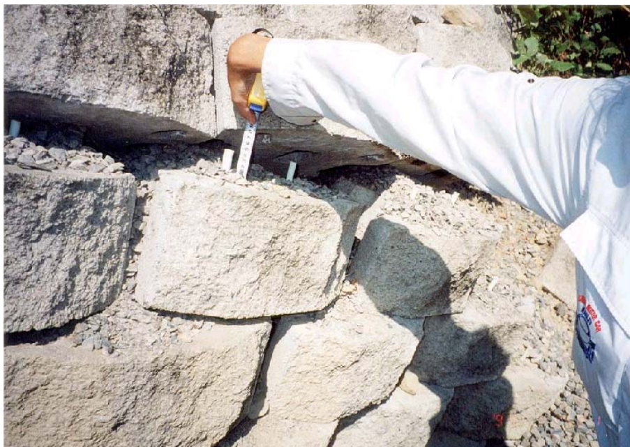
Figura 7 – Pormenor da deficiente ligação entre os blocos no muro apresentado na figura anterior ([4]).
