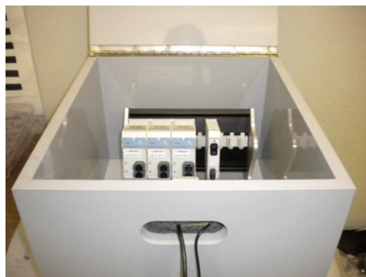
Figura 3.18 - Caixa de proteção da unidade de leitura
