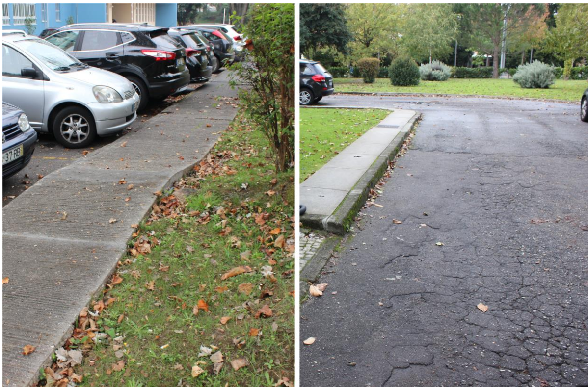
Figura 15 – Zona D: pavimentos degradados.
