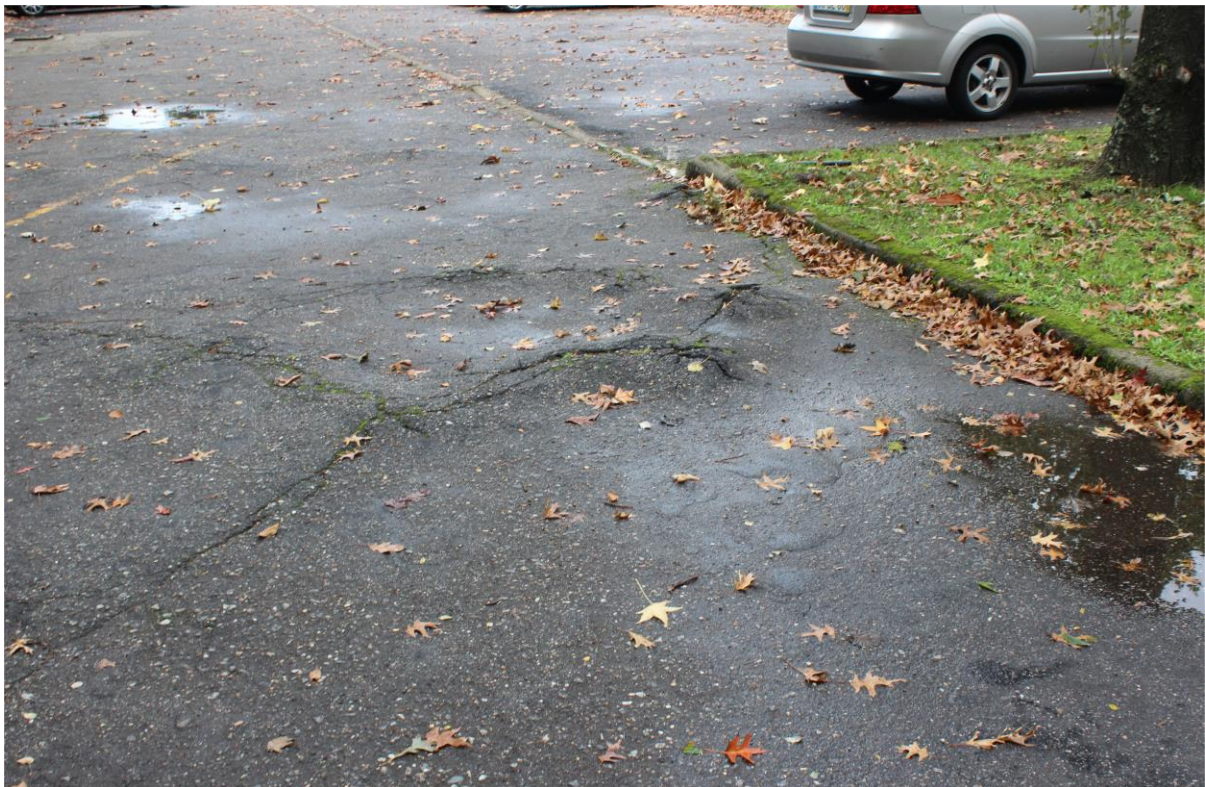
Figura 6 – Zona B: pavimento degradado pela emergência de raízes e poças de água.
