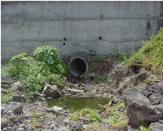
Baía dos Anjos. Linha de água entubada na travessia do arruamento marginal da obra aderente longitudinal (Santa Maria)
