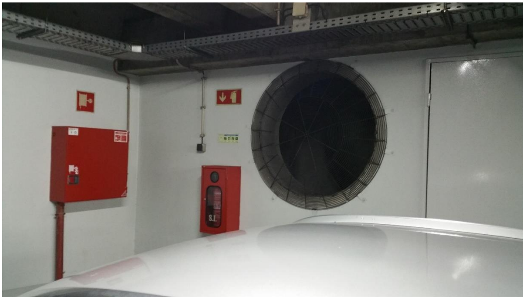
Fig. 5.19 - Ventilação de ar e elementos de segurança contra incêndio do Parque de Estacionamento dos Leões
