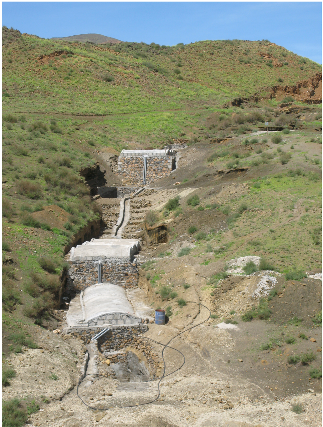
Fig. 30 Vista do conjunto dos Reservatórios.
