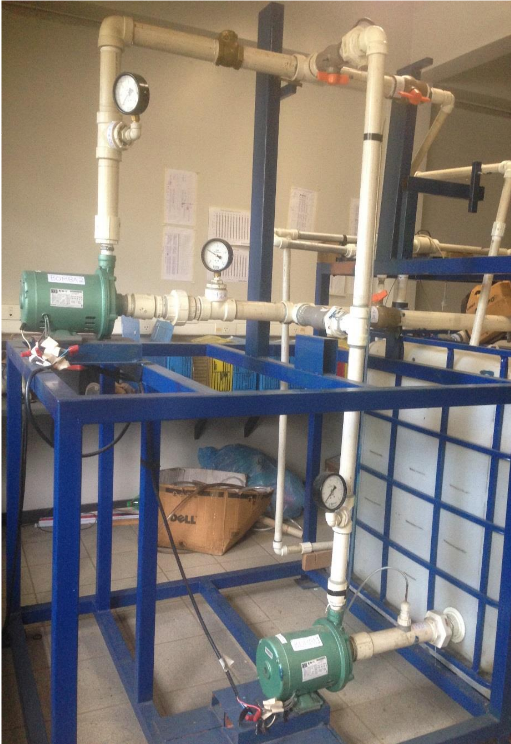
Figura 10 - Fotografia com as 2 bombas centrífugas Thebe
