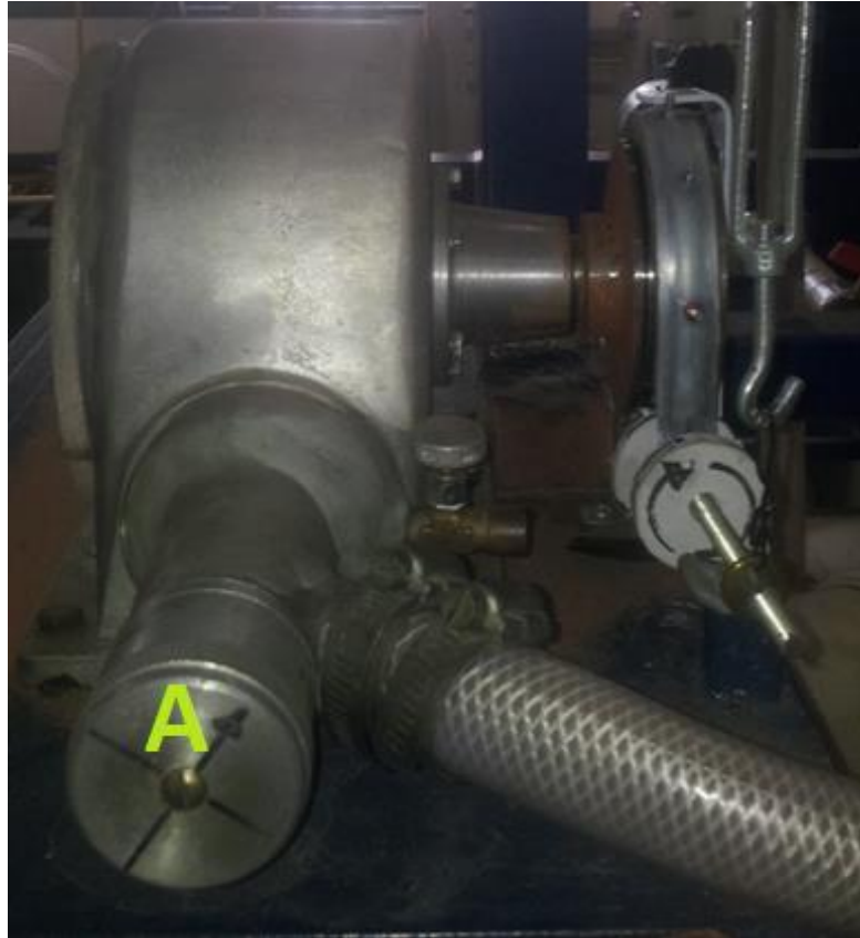
Figura 20 - Regulador de caudal da turbina
