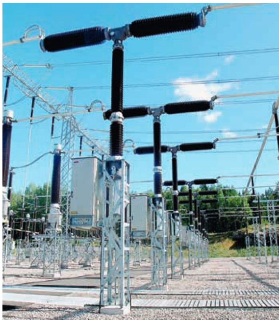
Figura 3.7: Disjuntor a SF6 para 400 kV com dupla câmara de corte.
