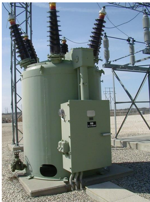
Figura 3.4: Disjuntor de Grande Volume de Óleo (GVO)
