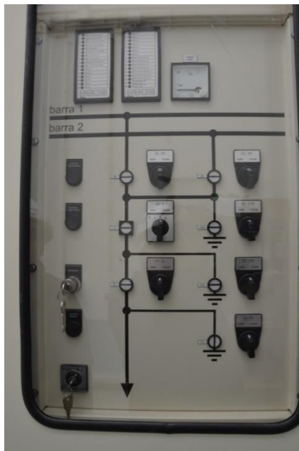
Figura 4.2: Detalhe do armário de comando do painel, numa subestação da REN.
