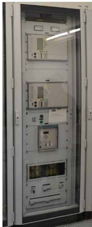
Figura 4.1: Posto de comando da subestação (esquerda) e armário de sistema de comando e controlo do painel (direita), numa subestação da REN.
