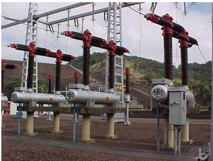
Figura 3.5: Disjuntor a ar comprimido
