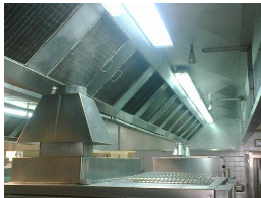
Fig.3.23 – Exaustor instalado na cozinha
