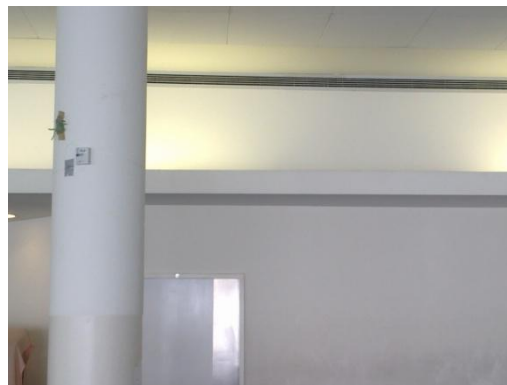
Fig.3.18 – Grelha de extração mecânica instalada na cantina
