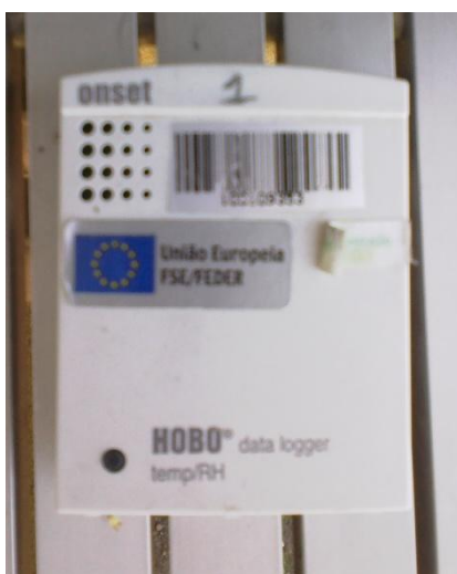
Fig.4.2 – Sensor Hobo Data Logger sobre a grelha de ventilação
