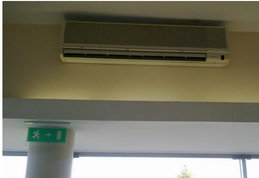
Fig.3.19 – Equipamento Multi-Split instalado no bar
