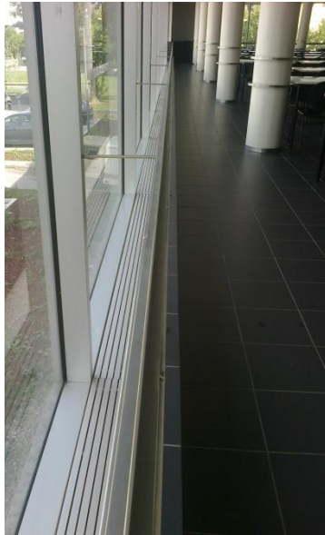
Fig.3.17 – Grelha de admissão natural de ar instalada na cantina
