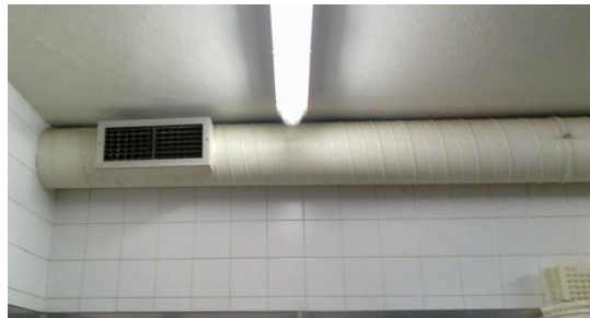
Fig.3.22 – Grelha de extração mecânica instalada na cozinha
