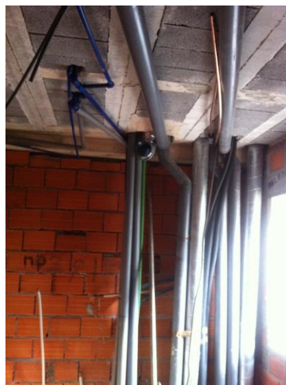
Fig. 3.20- Agrupamento de tubagens
