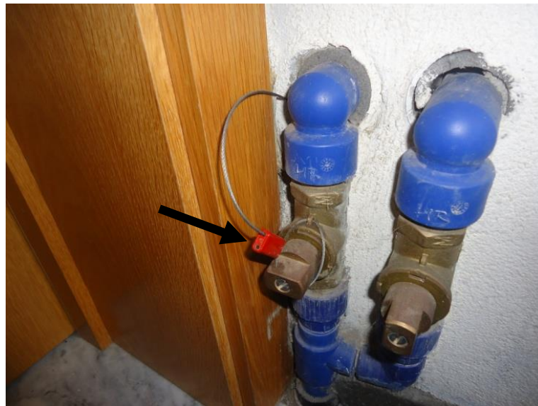
Fig. 2.30 - Selo colocado após o corte de água num cliente do SAA do Porto.
