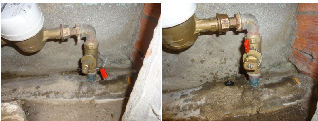
Fig. 4.64 - Ilícito detetado durante a verificação técnica efetuada à habitação do cliente XVI.
