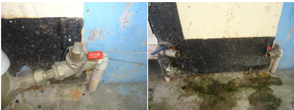
Fig. 4.60 - Ilícito detetado durante a verificação técnica efetuada à habitação do cliente XIV.
