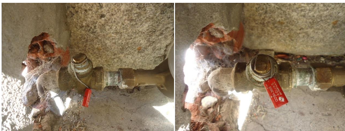
Fig. 4. 62 - Ilícito detetado durante a verificação técnica efetuada à habitação do cliente XV.
