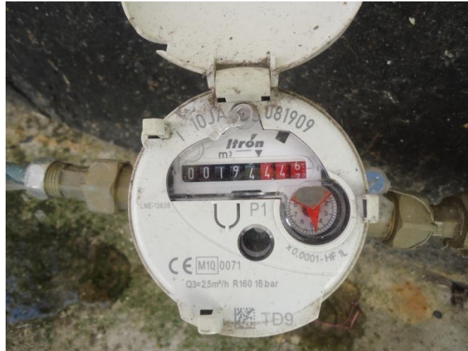
Fig. 4.59 - Leitura do contador após a suspensão do fornecimento de água do cliente XIV.
