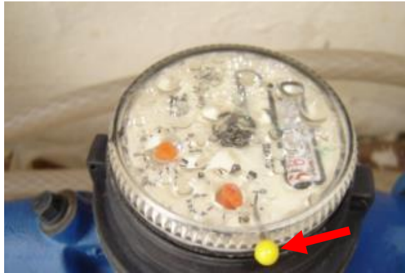
Fig. 2.20 - Contador violado com furo da cúpula (Pereira, 2007).
