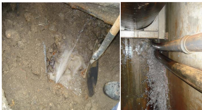
Fig. 2.10 - Fugas de água no SAA do Porto.
