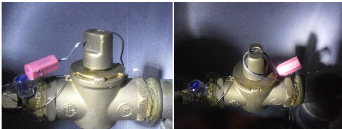
Fig. 4.54 - Ilícito detetado durante a verificação técnica à habitação XI.
